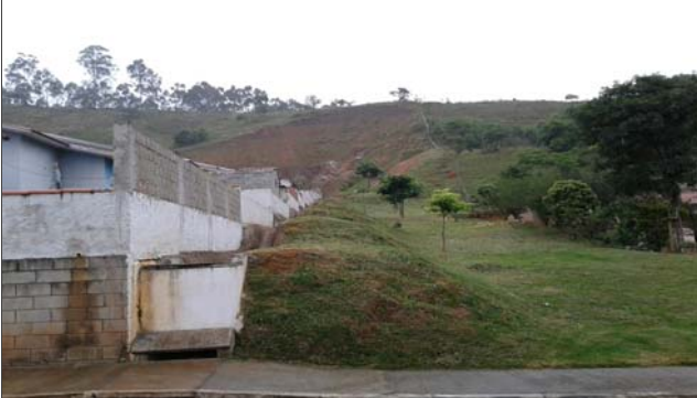
Foto: 1636721103061.jpg ID: 32 Visão geral do setor, Talude de corte com solo exposto
