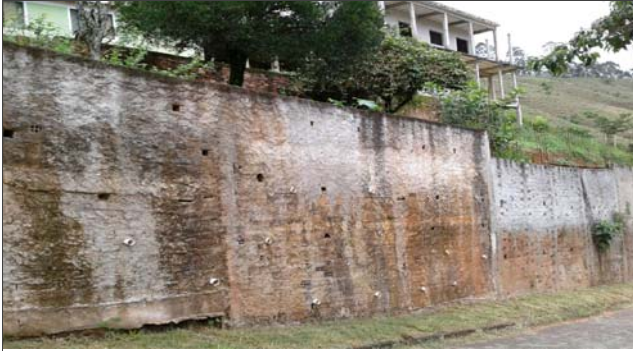
Foto: 1636719133815.jpg ID: 21 Detalhe para intervenção estrutural realizada para mitigação do risco, Moradia sujeita a risco de escorregamento
