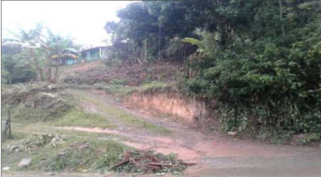
Foto: 1637316571056.jpg ID: 11 Visão geral do setor, Talude de corte com solo exposto
