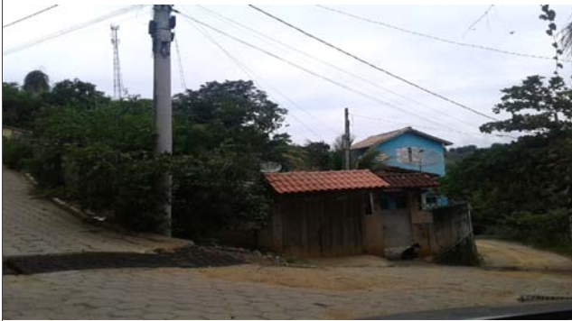
Foto: 1637240514162.jpg ID: 22 Visão geral do setor, Moradia sujeita a risco de escorregamento
