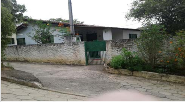
Foto: 1637239307470.jpg ID: 21 Visão geral do setor, Moradia sujeita a risco de escorregamento
