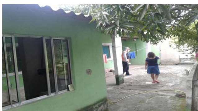
Foto: 1637261601355.jpg ID: 82 Moradia sujeita a risco de solapamento
