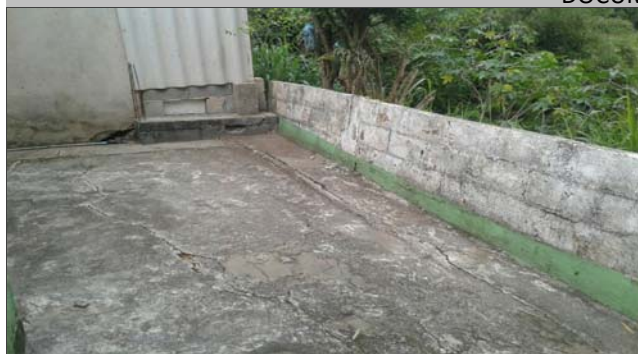
Foto: 1637261496126.jpg ID: 81 Evidência de movimentação no terreno
