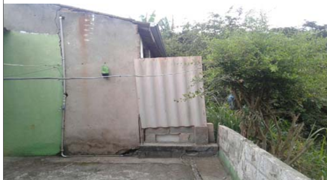
Foto: 1637261726118.jpg ID: 83 Evidência de movimentação em estruturas,
