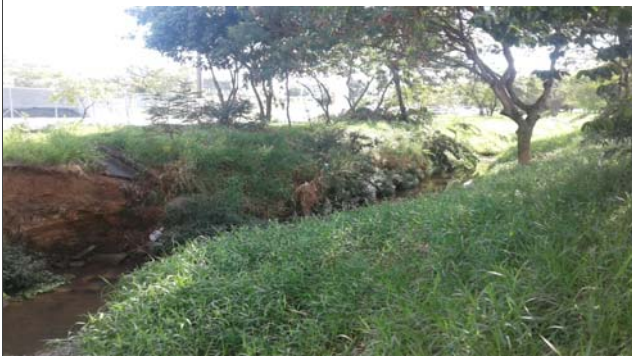
Foto: 1653057730761.jpg ID: 14 Detalhe do canal
