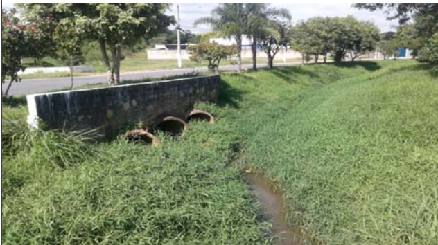
Foto: 1653056443624.jpg ID: 13 Detalhe do canal
