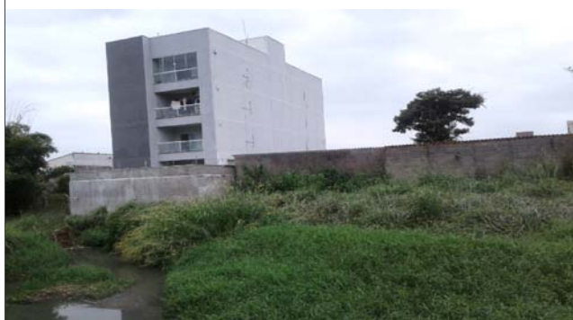
Foto: 1652981704376.jpg ID: 12 Moradia sujeita a risco de solapamento
