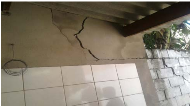
Foto: 1653491433843.jpg ID: 14 Evidência de movimentação em estruturas, Moradia sujeita a risco de solapamento
