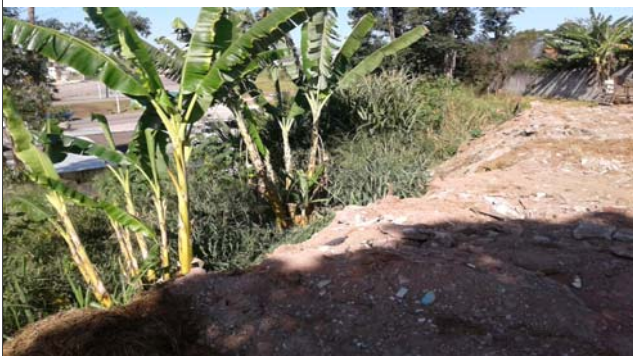
Foto: 1653412717393.jpg ID: 13 Talude de aterro inconsolidado
