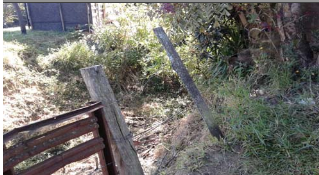
Foto: 1653398862146.jpg ID: 11 Detalhe do canal
