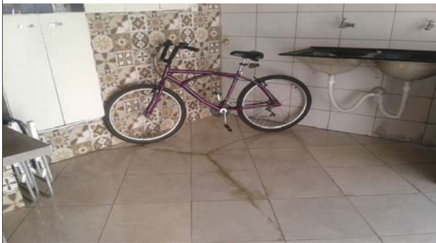
Foto: 1653491362723.jpg ID: 13 Evidência de movimentação em estruturas, Moradia sujeita a risco de solapamento
