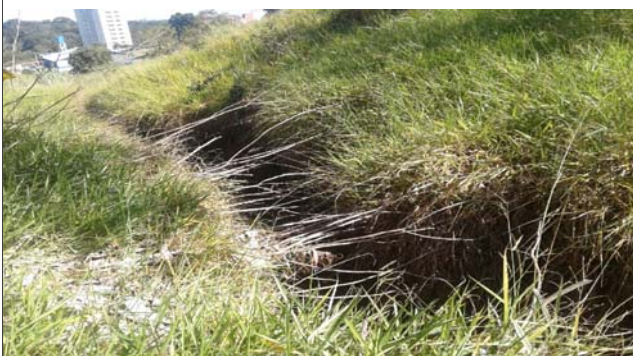
Foto: 1653658824216.jpg ID: 13 Visão geral do setor, Detalhe para processo de erosão, Detalhe para processo de ravinamento, Evidência de movimentação no terreno, Formação de processo erosivo
