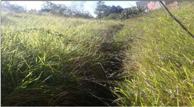
Foto: 1653658452944.jpg ID: 11 Visão geral do setor, Detalhe para processo de erosão, Detalhe para processo de ravinamento, Evidência de movimentação no terreno, Formação de processo erosivo, Moradia sujeita a processos de erosão
