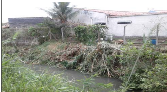
Foto: 1652982175454.jpg ID: 13 Detalhe do canal, Detalhe para processo de erosão, Detalhe para processo de solapamento no talude, Presença de cicatriz de escorregamento pretérito, Evidência de movimentação no terreno, Formação de processo erosivo, Moradia sujeita a risco de solapamento
