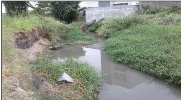
Foto: 1652981660699.jpg ID: 11 Visão geral do setor, Visão geral da drenagem, Detalhe do canal, Detalhe para processo de erosão, Depósito de escorregamento pretérito, Presença de cicatriz de escorregamento pretérito, Evidência de movimentação em estruturas, Formação de processo erosivo
