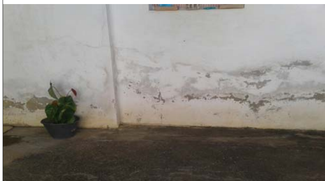
Foto: 1653667425269.jpg ID: 12 Detalhe para marca de água
