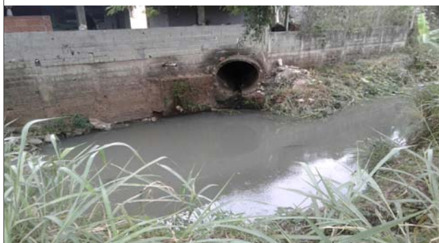
Foto: 1652982524409.jpg ID: 14 Detalhe do canal, Detalhe para processo de solapamento no talude, Formação de processo erosivo, Lançamento de águas/esgoto na superfície, Moradia sujeita a risco de solapamento
