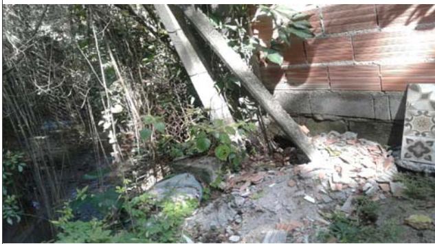
Foto: 1653491295135.jpg ID: 12 Detalhe para processo de erosão, Detalhe para processo de solapamento no talude marginal, Evidência de movimentação em estruturas e no terreno, Moradia sujeita a risco de solapamento
