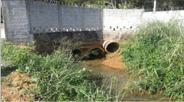
Foto: 1653055575010.jpg ID: 11 Detalhe do canal
