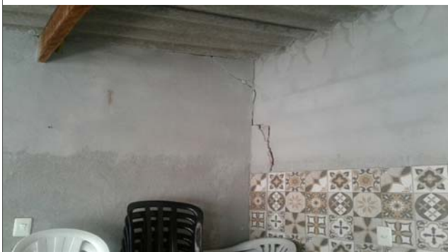
Foto: 1653491504790.jpg ID: 15 Evidência de movimentação no terreno, Moradia sujeita a risco de solapamento
