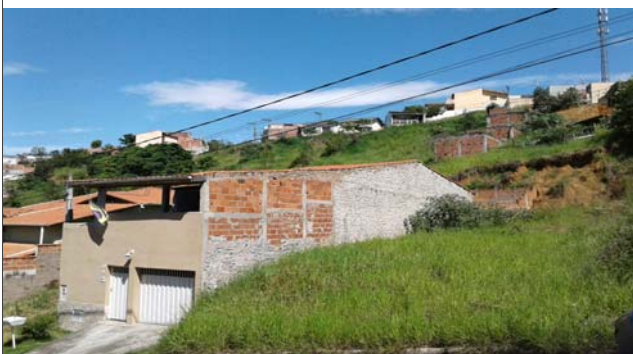
Foto: 1640172692741.jpg ID: 14 Formação de processo erosivo, Talude de corte com solo exposto
