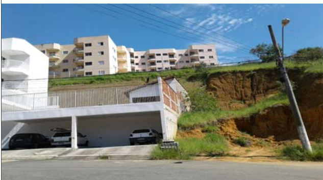
Foto: 1640172661796.jpg ID: 13 Presença de cicatriz de escorregamento pretérito, Talude de corte com solo exposto
