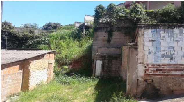
Foto: 1640015382253.jpg ID: 33 Visão geral do setor, Formação de processo erosivo, Moradia sujeita a risco de escorregamento, Presença de cicatriz de escorregamento pretérito, Talude de corte com solo exposto
