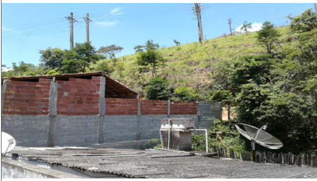
Foto: 1640178644072.jpg ID: 34 Talude de corte com solo exposto
