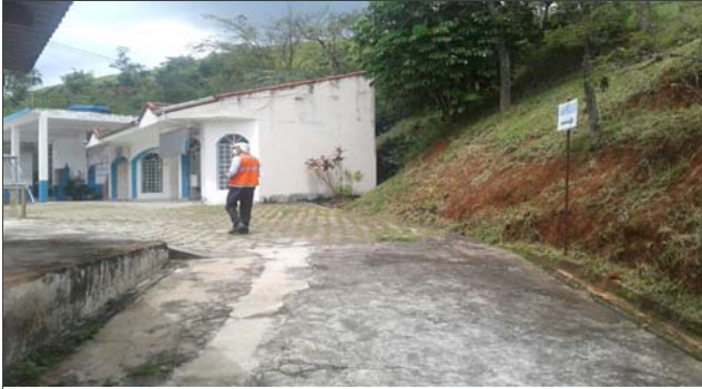
Foto: 1641395553621.jpg ID: 11 Formação de processo erosivo, Talude de corte com solo exposto
