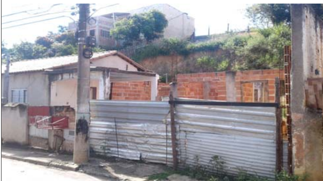
Foto: 1640019788595.jpg ID: 43 Formação de processo erosivo, Talude de corte com solo exposto
