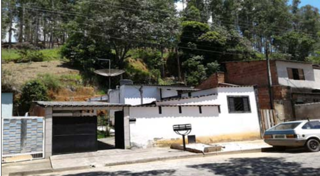
Foto: 1640178614768.jpg ID: 33 Formação de processo erosivo, Talude de corte com solo exposto
