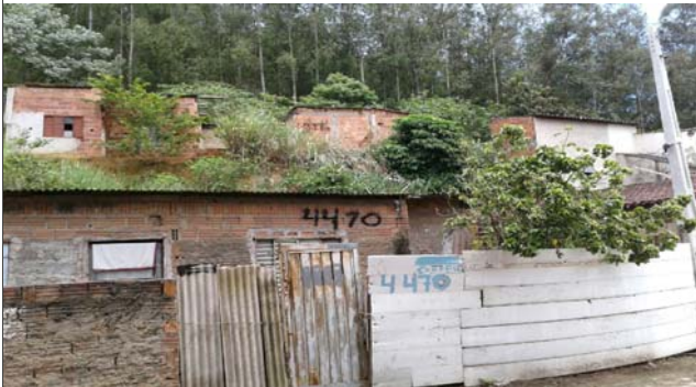
Foto: 1641215421162.jpg ID: 12 Visão geral do setor, Moradia sujeita a risco de escorregamento, Talude de corte com solo exposto, Moradias próximas ao topo do talude de corte
