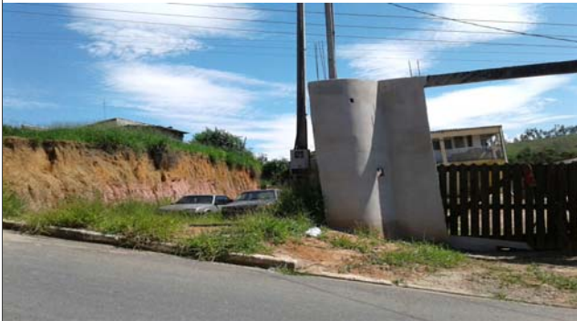
Foto: 1640172597862.jpg ID: 12 Formação de processo erosivo, Talude de corte com solo exposto
