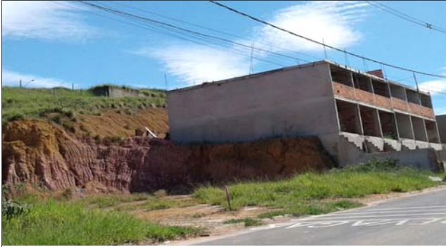
Foto: 1640172538898.jpg ID: 11 Formação de processo erosivo, Talude de corte com solo exposto
