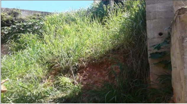
Foto: 1640015233423.jpg ID: 31 Formação de processo erosivo, Presença de cicatriz de escorregamento pretérito, Talude de corte com solo exposto
