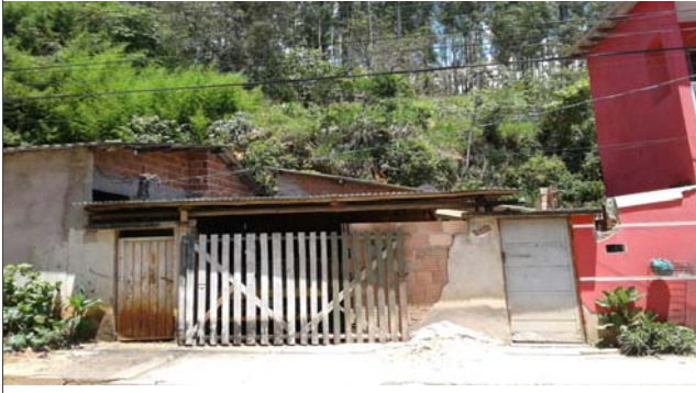
Foto: 1640178577719.jpg ID: 32 Talude de corte com solo exposto
