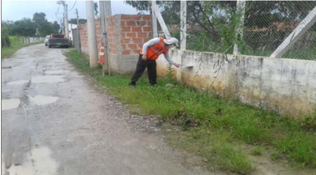
Foto: 1641404757855.jpg ID: 12 Detalhe para marca de água,
