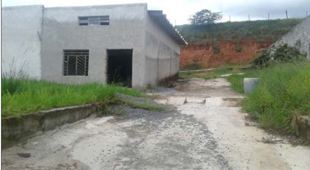
Foto: 1641399942215.jpg ID: 41 Talude de corte com solo exposto
