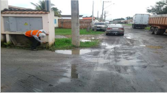
Foto: 1641472315669.jpg ID: 32 Detalhe para marca de água
