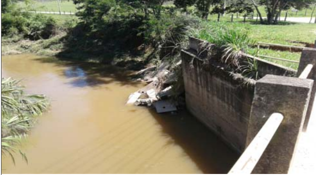
Foto: 1640089986340.jpg ID: 21 Detalhe do canal, Detalhe para processo de solapamento no talude marginal, Presença de cicatriz de escorregamento pretérito
