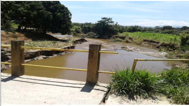
Foto: 1640090205781.jpg ID: 23 Visão geral da drenagem, Detalhe para processo de solapamento no talude marginal
