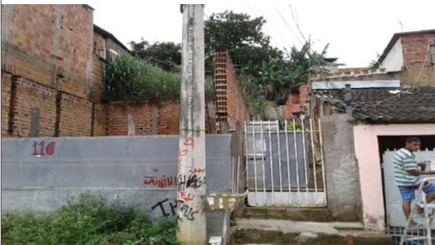
Foto: 1639656653766.jpg ID: 24 Talude de corte com solo exposto
