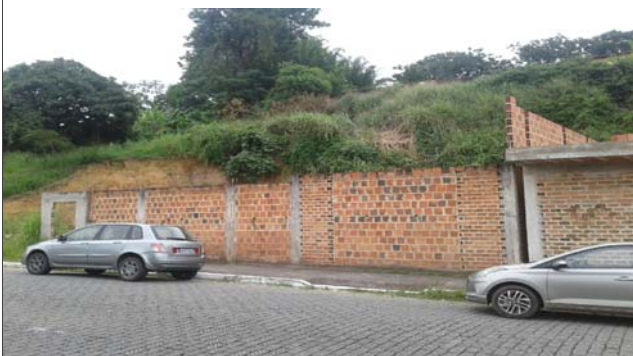
Foto: 1639507897625.jpg ID: 64 Visão geral do setor, Moradia sujeita a risco de escorregamento
