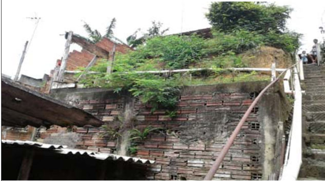
Foto: 1639741528990.jpg ID: 22 Evidência de movimentação em estruturas, Moradia sujeita a risco de escorregamento, Talude de corte com solo exposto
