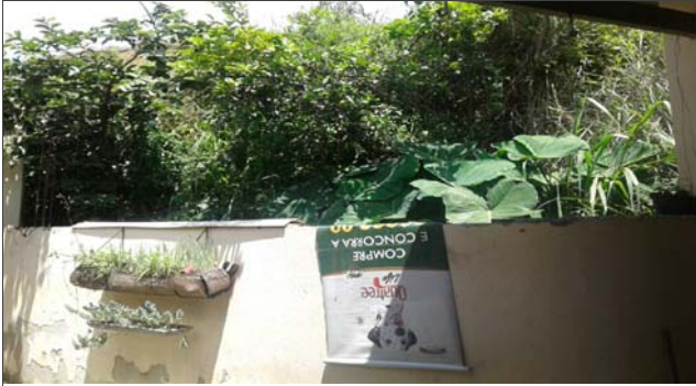
Foto: 1639139682621.jpg ID: 11 Talude de corte
