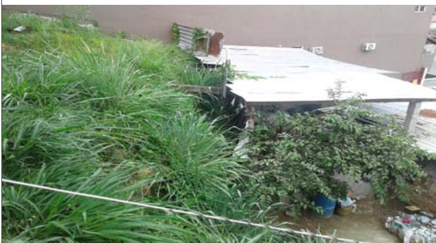
Foto: 1639507649513.jpg ID: 63 Talude de corte com solo exposto
