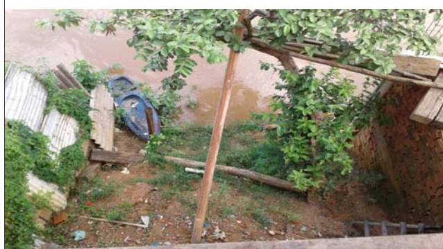
Foto: 1639075783151.jpg ID: 12 Detalhe do canal, Moradia sujeita a risco de solapamento
