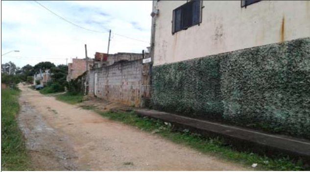
Foto: 1639668051830.jpg ID: 61 Talude de corte com solo exposto
