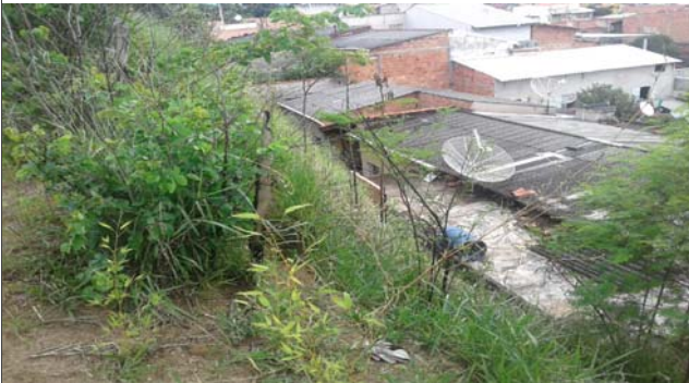
Foto: 1639417404097.jpg ID: 32 Moradia sujeita a risco de escorregamento, Talude de corte com solo exposto
