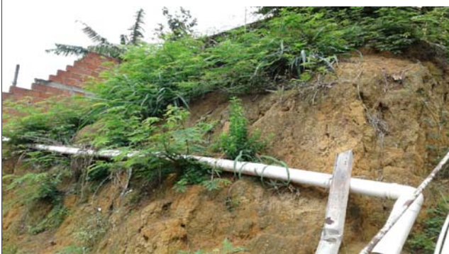
Foto: 1639741596321.jpg ID: 23 Presença de cicatriz de escorregamento pretérito, Talude de corte com solo exposto
