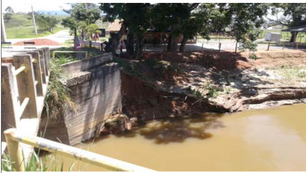
Foto: 1640090157443.jpg ID: 22 Detalhe do canal, Detalhe para processo de solapamento no talude marginal, Presença de cicatriz de escorregamento pretérito
