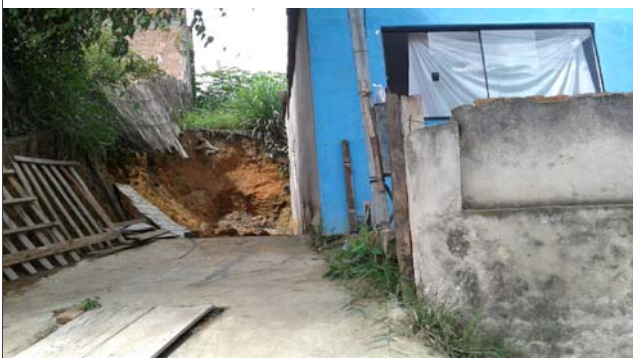
Foto: 1639671500067.jpg ID: 74 Moradia sujeita a risco de escorregamento, Talude de corte com solo exposto
