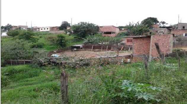
Foto: 1639658800436.jpg ID: 35 Visão geral do setor, Moradia sujeita a risco de escorregamento
