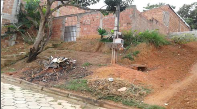
Foto: 1639656489584.jpg ID: 22 Moradia sujeita a risco de escorregamento, Talude de corte com solo exposto
