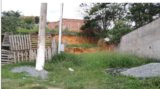
Foto: 1639675662122.jpg ID: 93 Talude de corte com solo exposto
