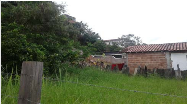
Foto: 1639507572447.jpg ID: 62 Moradia sujeita a risco de escorregamento, Talude de corte e talude natural
