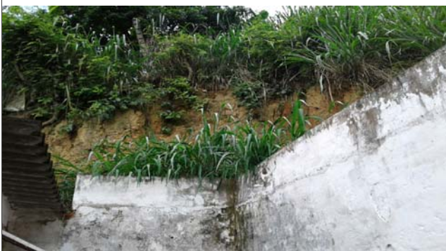
Foto: 1639739913446.jpg ID: 14 Formação de processo erosivo, Talude de corte com solo exposto
