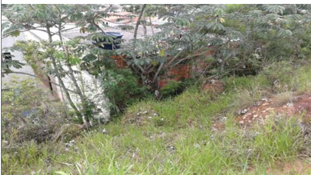
Foto: 1639574632984.jpg ID: 34 Moradia sujeita a risco de escorregamento, Talude de corte com solo exposto
