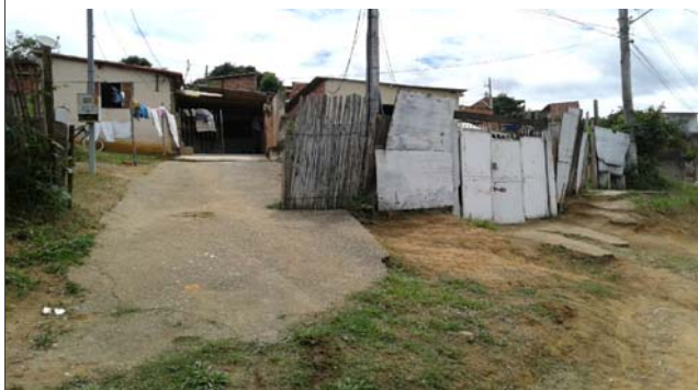
Foto: 1639668571903.jpg ID: 54 Moradia sujeita a risco de escorregamento
