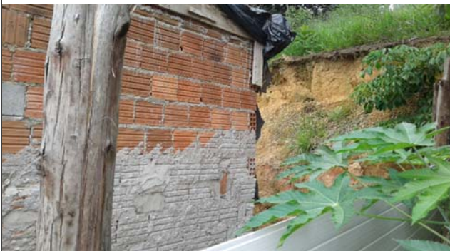
Foto: 1639658384935.jpg ID: 34 Talude de corte com solo exposto
