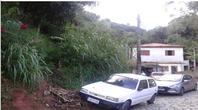
Foto: 1649189669731.jpg ID: 33 Visão geral do setor, Depósito de escorregamento pretérito, Formação de processo erosivo, Moradia sujeita a risco de escorregamento, Talude de corte com solo exposto
