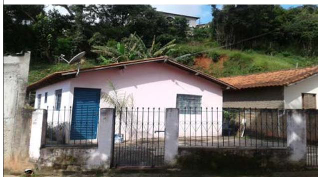
Foto: 1649265777634.jpg ID: 53 Formação de processo erosivo, Moradia sujeita a risco de escorregamento, Presença de cicatriz de escorregamento pretérito, Talude de corte com solo exposto
