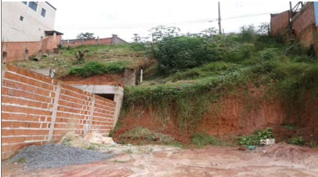
Foto: 1649252972569.jpg ID: 22 Talude de corte com solo exposto
