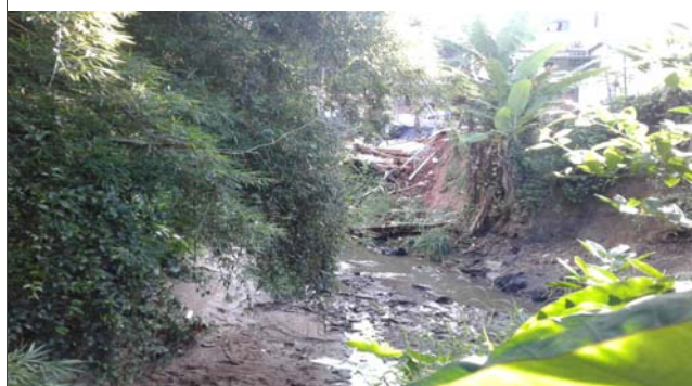
Foto: 1649101812378.jpg ID: 14 Presença de cicatriz de escorregamento pretérito, Formação de processo erosivo, Moradia sujeita a processos de erosão
