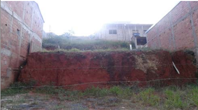
Foto: 1649272706208.jpg ID: 12 Visão geral do setor, Talude de corte com solo exposto
