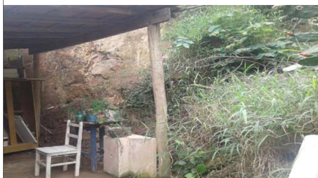
Foto: 1649337180510.jpg ID: 22 Depósito de escorregamento pretérito, Formação de processo erosivo, Moradia sujeita a risco de escorregamento, Presença de cicatriz de escorregamento pretérito, Talude de corte com solo exposto
