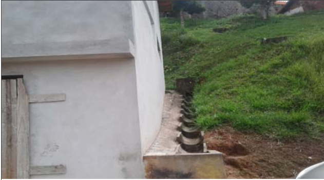
Foto: 1649342734892.jpg ID: 41 Detalhe para intervenção estrutural realizada para mitigação do risco
