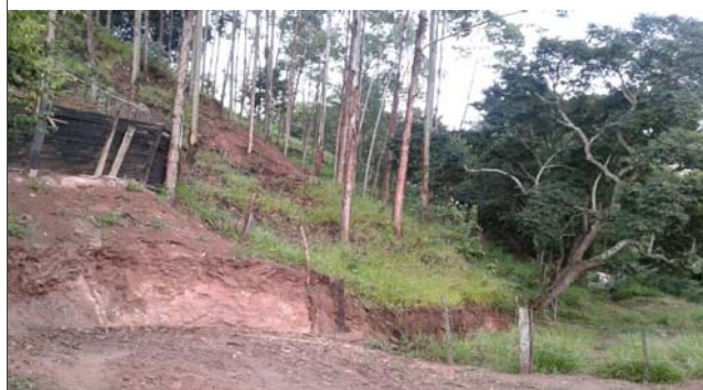
Foto: 1649183271221.jpg ID: 13 Evidência de movimentação no terreno, Formação de processo erosivo, Presença de árvore inclinada, Talude de corte com solo exposto
