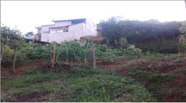
Foto: 1649272463826.jpg ID: 11 Talude de corte com solo exposto
