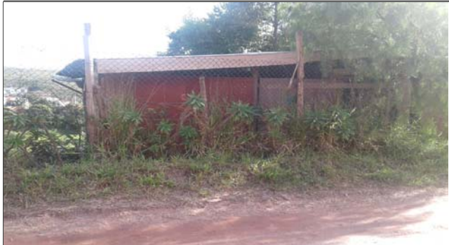
Foto: 1649357198248.jpg ID: 21 Visão geral do setor, Moradia sujeita a processos de erosão
