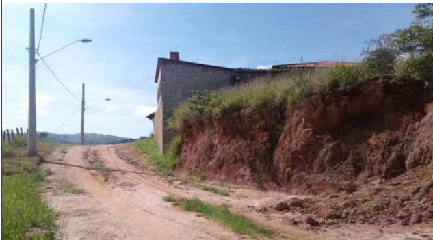
Foto: 1649425235420.jpg ID: 23 Visão geral do setor, Talude de corte com solo exposto
