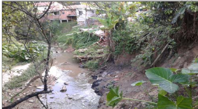
Foto: 1649099334731.jpg ID: 11 Detalhe do canal, Depósito de escorregamento pretérito, Evidência de movimentação no terreno, Formação de processo erosivo, Moradia sujeita a risco de solapamento
