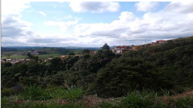
Foto: 1649356134981.jpg ID: 12 Visão geral do setor, Formação de processo erosivo, Moradia sujeita a risco de escorregamento, Presença de árvore inclinada, Talude de corte com solo exposto
