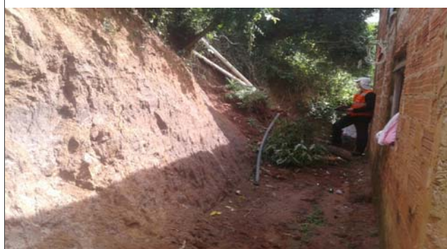
Foto: 1649338232586.jpg ID: 23 Depósito de escorregamento pretérito, Formação de processo erosivo, Moradia sujeita a risco de escorregamento, Presença de cicatriz de escorregamento pretérito, Talude de corte com solo exposto
