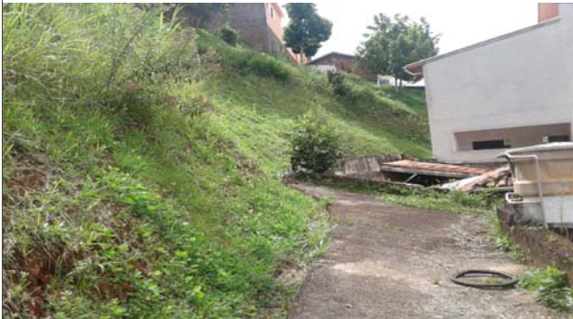
Foto: 1649342834624.jpg ID: 42 Depósito de escorregamento pretérito, Detalhe para intervenção estrutural realizada para mitigação do risco, Formação de processo erosivo, Moradia sujeita a risco de escorregamento
