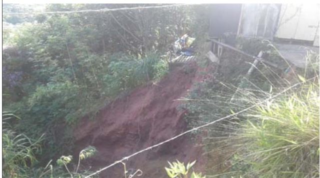
Foto: 1649357415258.jpg ID: 22 Visão geral do setor, Detalhe para processo de erosão e de ravinamento, Depósito e cicatriz de escorregamento pretérito, Evidência de movimentação em estruturas e no terreno, Formação de processo erosivo, Moradia sujeita a processos de erosão
