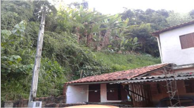
Foto: 1649189444334.jpg ID: 32 Depósito de escorregamento pretérito, Formação de processo erosivo, Moradia sujeita a risco de escorregamento, Talude de corte com solo exposto
