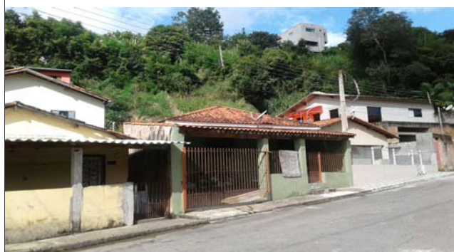
Foto: 1649267219059.jpg ID: 54 Visão geral do setor, Formação de processo erosivo, Moradia sujeita a risco de escorregamento, Presença de cicatriz de escorregamento pretérito, Talude de corte com solo exposto
