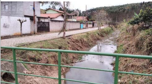
Foto: 1660139837621.jpg ID: 36 Detalhe do canal
