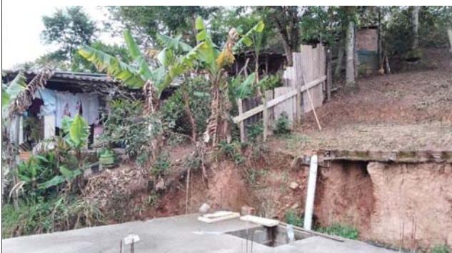
Foto: 1660059296140.jpg ID: 25 Talude de corte com solo exposto
