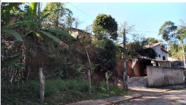
Foto: 1660567531678.jpg ID: 35 Talude de corte com solo exposto
