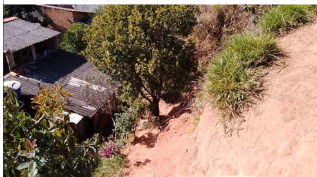
Foto: 1659533394870.jpg ID: 24 Talude de corte com solo exposto
