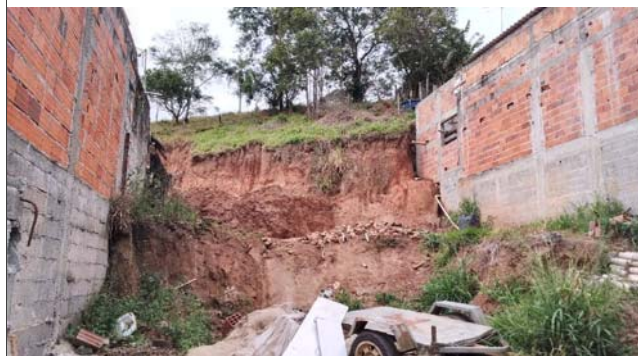
Foto: 1660059742169.jpg ID: 32 Talude de corte com solo exposto
