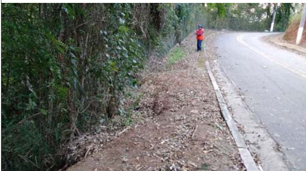
Foto: 1660564319914.jpg ID: 14 Evidência de movimentação no terreno
