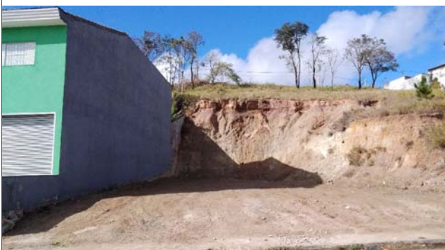
Foto: 1660309079707.jpg ID: 14 Talude de corte com solo exposto
