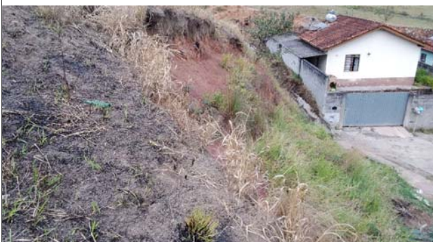
Foto: 1660314092050.jpg ID: 36 Depósito de escorregamento pretérito, Evidência de movimentação no terreno, Formação de processo erosivo, Presença de cicatriz de escorregamento pretérito, Talude de corte com solo exposto
