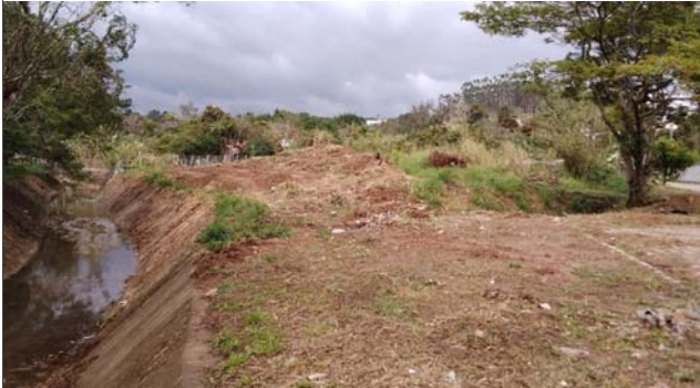
Foto: 1660139697953.jpg ID: 34 Detalhe do canal
