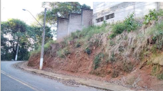
Foto: 1660567465795.jpg ID: 34 Talude de corte com solo exposto
