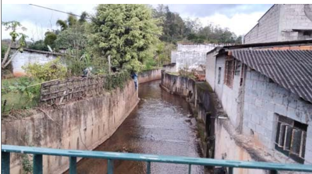
Foto: 1660223361723.jpg ID: 26 Detalhe do canal
