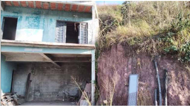
Foto: 1659557093943.jpg ID: 43 Moradia sujeita a risco de escorregamento, Talude de corte com solo exposto
