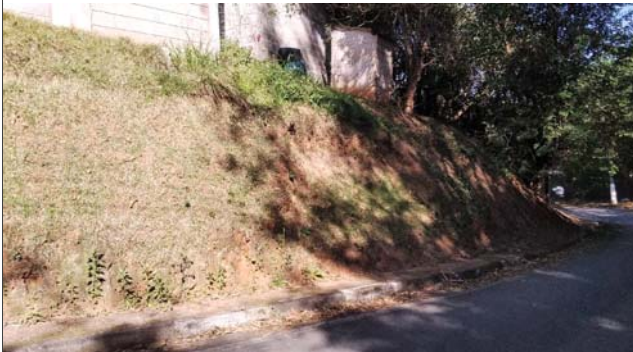
Foto: 1660567317576.jpg ID: 33 Depósito de escorregamento pretérito
