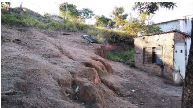
Foto: 1660161954004.jpg ID: 45 Formação de processo erosivo
