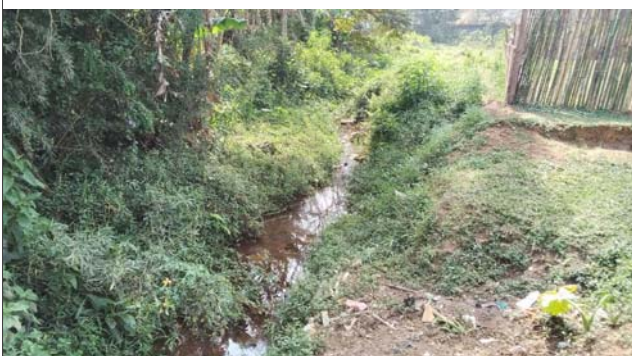
Foto: 1659627503785.jpg ID: 14 Detalhe do canal
