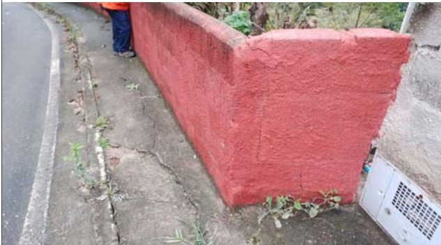
Foto: 1659973190397.jpg ID: 22 Evidência de movimentação em estruturas
