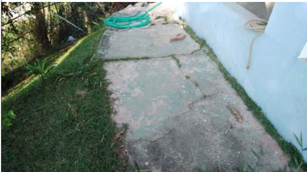
Foto: 1659557190676.jpg ID: 44 Evidência de movimentação no terreno
