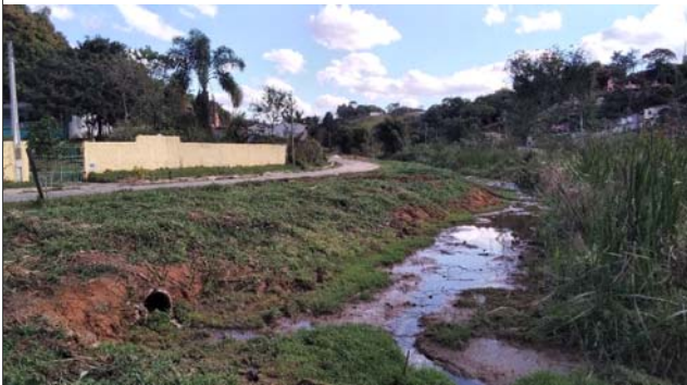
Foto: 1660156024665.jpg ID: 12 Detalhe do canal
