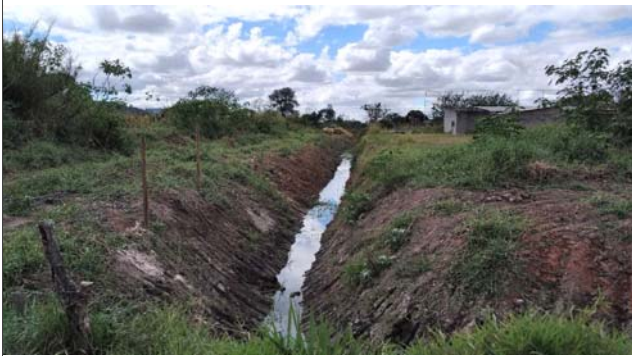
Foto: 1660317386086.jpg ID: 13 Detalhe do canal
