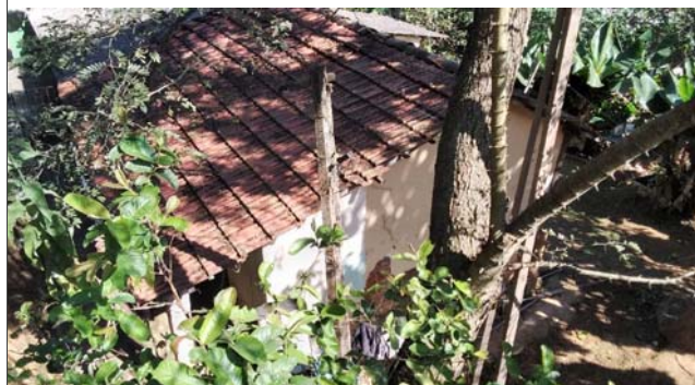
Foto: 1659546926152.jpg ID: 12 Evidência de movimentação em estruturas
