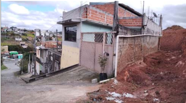
Foto: 1660313978753.jpg ID: 34 Moradia sujeita a risco de escorregamento, Talude de corte com solo exposto
