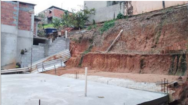
Foto: 1660073279386.jpg ID: 12 Talude de corte com solo exposto
