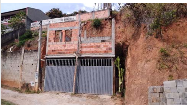
Foto: 1660660295274.jpg ID: 13 Moradia sujeita a risco de escorregamento, Talude de corte com solo exposto
