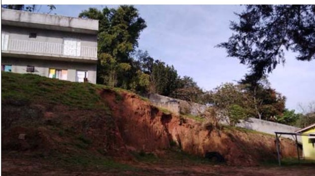
Foto: 1660652349534.jpg ID: 15 Talude de corte com solo exposto
