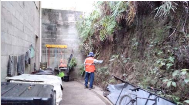
Foto: 1659465662222.jpg ID: 13 Talude de corte com solo exposto
