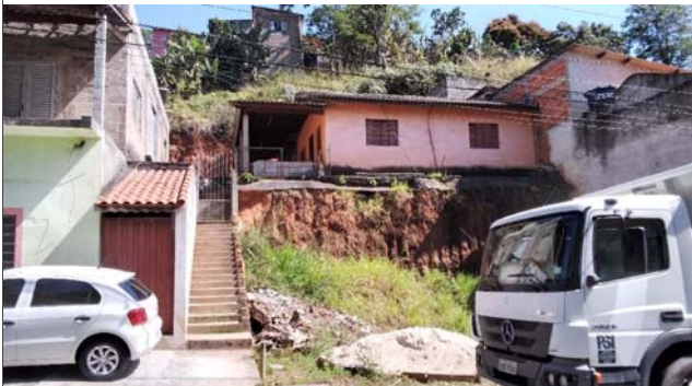
Foto: 1660584405604.jpg ID: 13 Moradia sujeita a risco de escorregamento, Talude de corte com solo exposto
