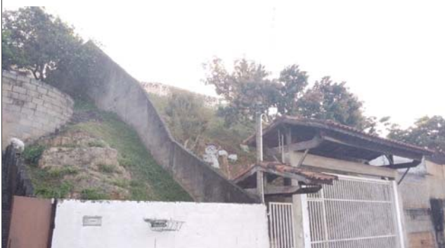
Foto: 1660592001793.jpg ID: 36 Presença de cicatriz de escorregamento pretérito, Talude de corte com solo exposto
