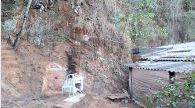
Foto: 1659465482216.jpg ID: 12 Talude de corte com solo exposto
