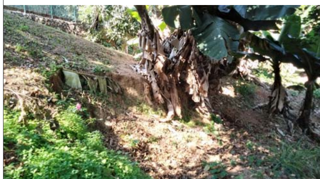
Foto: 1659547127994.jpg ID: 14 Evidência de movimentação no terreno, Formação de processo erosivo
