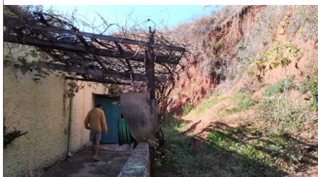
Foto: 1659531557673.jpg ID: 23 Presença de cicatriz de escorregamento pretérito, Talude de corte com solo exposto
