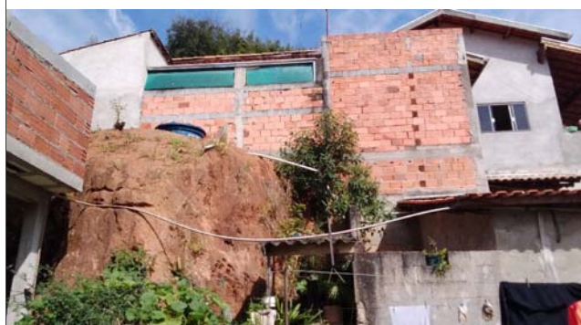
Foto: 1660661542662.jpg ID: 25 Moradia sujeita a risco de escorregamento, Talude de corte com solo exposto
