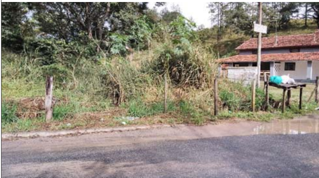
Foto: 1660135140251.jpg ID: 14 Detalhe do canal
