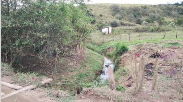
Foto: 1660071362995.jpg ID: 12 Detalhe do canal
