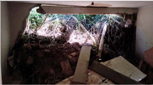
Foto: 1660584822468.jpg ID: 23 Depósito de escorregamento pretérito, Evidência de movimentação em estruturas, Moradia sujeita a risco de escorregamento
