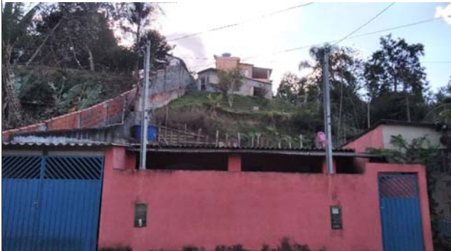
Foto: 1660161823514.jpg ID: 43 Evidência de movimentação no terreno
