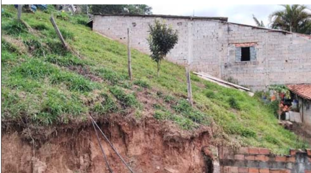
Foto: 1660059392682.jpg ID: 26 Evidência de movimentação no terreno
