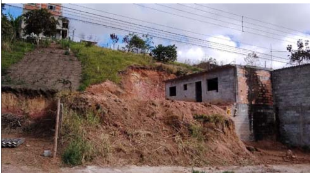
Foto: 1660309201863.jpg ID: 15 Talude de corte com solo exposto
