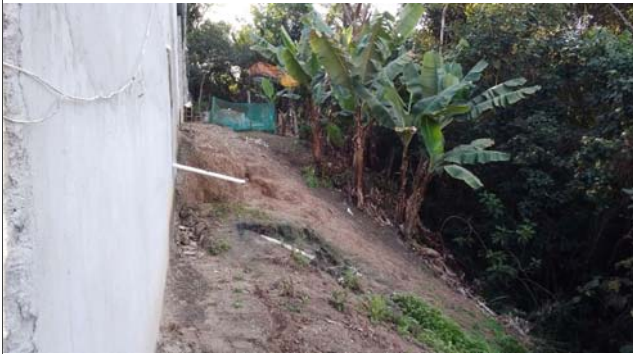
Foto: 1660160591287.jpg ID: 33 Talude de corte com solo exposto
