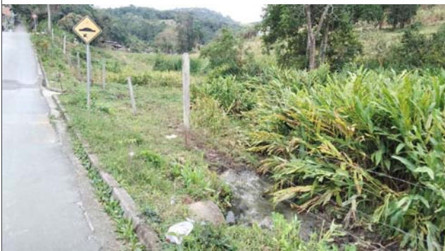
Foto: 1660058454093.jpg ID: 14 Detalhe do canal
