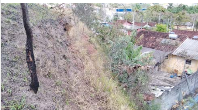
Foto: 1660314246607.jpg ID: 37 Moradia sujeita a risco de escorregamento
