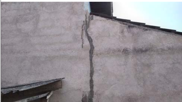
Foto: 1659557306013.jpg ID: 45 Evidência de movimentação em estruturas
