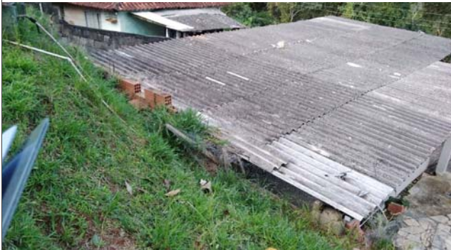
Foto: 1660565418798.jpg ID: 23 Moradia sujeita a risco de escorregamento
