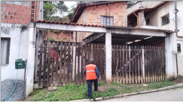
Foto: 1660059100816.jpg ID: 22 Moradia sujeita a risco de escorregamento
