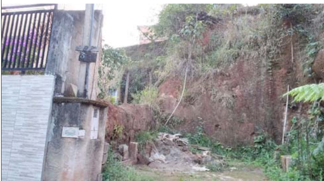
Foto: 1660565501069.jpg ID: 24 Talude de corte com solo exposto
