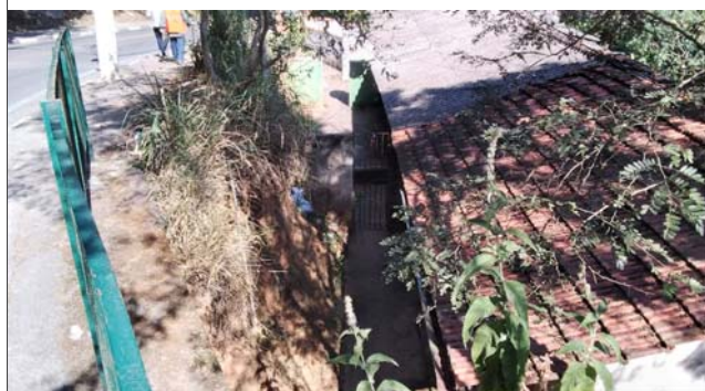
Foto: 1659547029451.jpg ID: 13 Moradia sujeita a risco de escorregamento, Talude de corte com solo exposto
