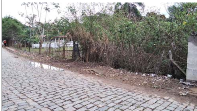
Foto: 1660142368766.jpg ID: 46 Detalhe do canal
