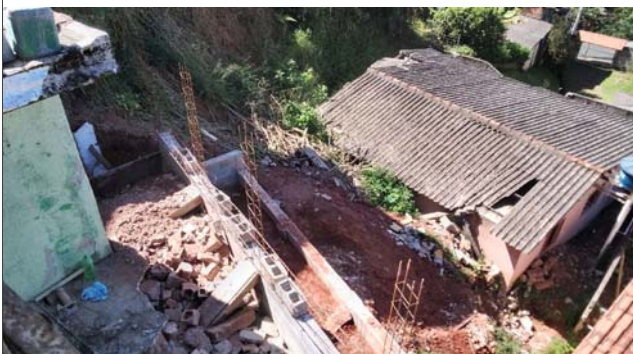
Foto: 1660585035643.jpg ID: 26 Depósito de escorregamento pretérito
