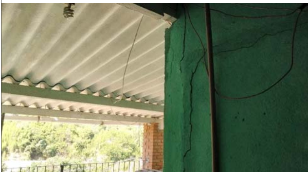
Foto: 1660585192227.jpg ID: 26 Evidência de movimentação em estruturas
