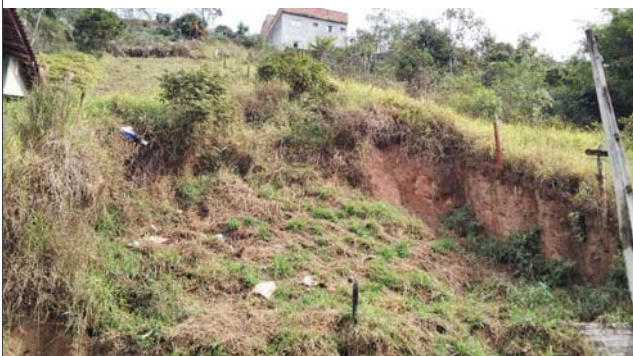
Foto: 1659973326300.jpg ID: 24 Depósito de escorregamento pretérito, Talude de corte com solo exposto
