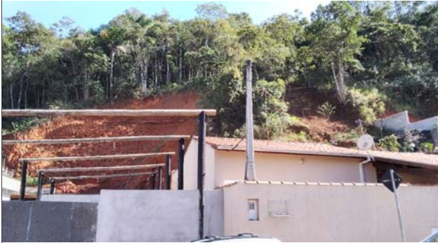
Foto: 1660571408996.jpg ID: 43 Depósito de escorregamento pretérito, Moradia sujeita a risco de escorregamento, Talude de corte com solo exposto
