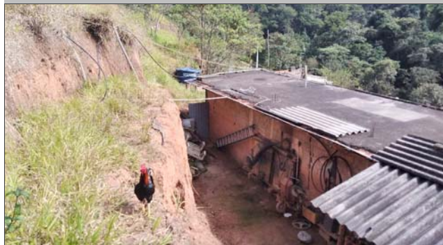
Foto: 1660661272273.jpg ID: 22 Moradia sujeita a risco de escorregamento, Talude de corte com solo exposto
