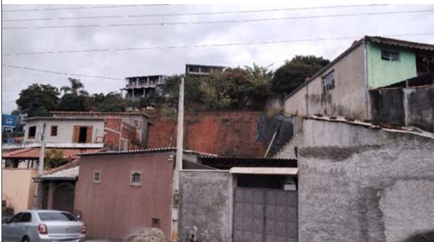
Foto: 1659987549645.jpg ID: 14 Moradia sujeita a risco de escorregamento, Talude de corte com solo exposto
