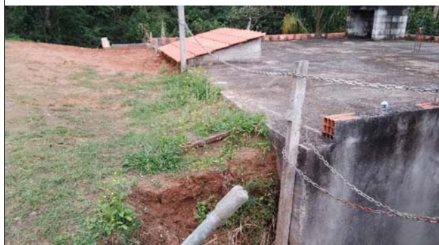
Foto: 1660059902598.jpg ID: 34 Talude de corte com solo exposto
