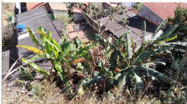
Foto: 1659533519993.jpg ID: 25 Presença de bananeiras na base do talude de corte
