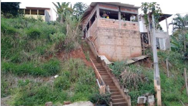
Foto: 1660046608745.jpg ID: 13 Moradia sujeita a risco de escorregamento
