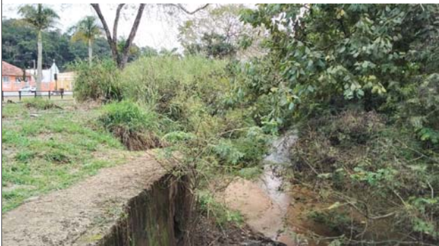
Foto: 1660053122673.jpg ID: 13 Detalhe do canal
