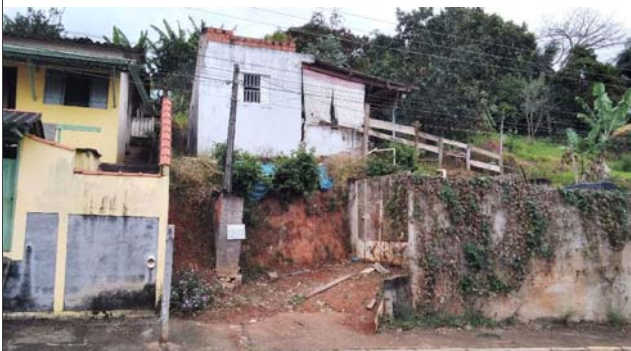
Foto: 1659987612971.jpg ID: 15 Moradia sujeita a risco de escorregamento, Talude de corte com solo exposto
