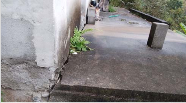
Foto: 1659973151577.jpg ID: 21 Evidência de movimentação em estruturas
