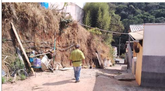
Foto: 1660661462817.jpg ID: 24 Talude de corte com solo exposto
