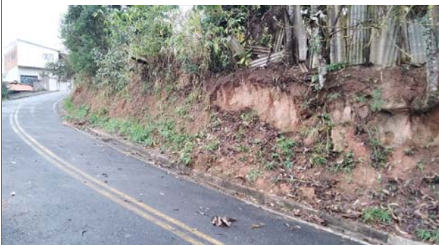
Foto: 1659973290578.jpg ID: 23 Talude de corte com solo exposto
