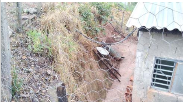
Foto: 1659973686885.jpg ID: 13 Talude de corte com solo exposto
