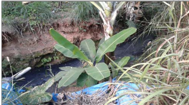
Foto: 1660855532403.jpg ID: 31 Detalhe para processo de solapamento no talude marginal, Presença de cicatriz de escorregamento pretérito, Formação de processo erosivo
