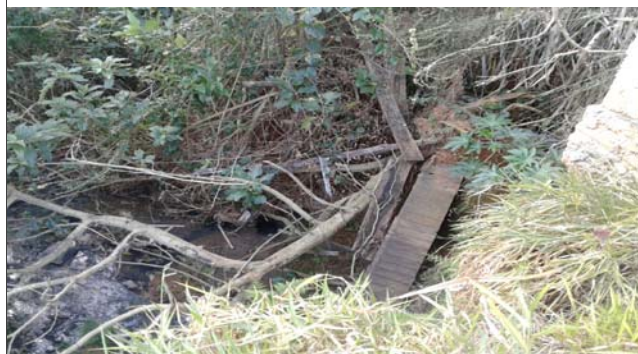
Foto: 1660850612327.jpg ID: 13 Detalhe para processo de solapamento no talude marginal, Moradia sujeita a risco de solapamento
