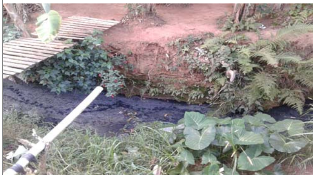
Foto: 1660855748871.jpg ID: 33 Detalhe do canal, Presença de cicatriz de escorregamento pretérito, Lançamento de águas/esgoto na superfície
