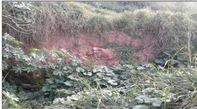
Foto: 1660850188720.jpg ID: 11 Detalhe para processo de solapamento no talude marginal, Presença de cicatriz de escorregamento pretérito, Formação de processo erosivo
