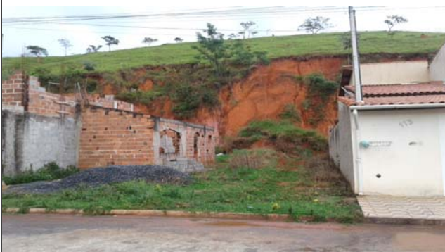
Foto: 1649880048123.jpg ID: 13 Talude de corte com solo exposto
