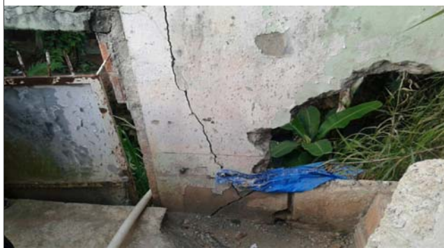
Foto: 1660855617601.jpg ID: 32 Evidência de movimentação em estruturas, Moradia sujeita a risco de solapamento
