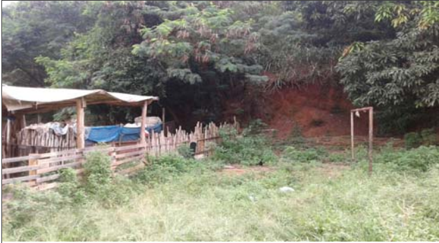
Foto: 1649854370167.jpg ID: 11 Visão geral do setor, Moradia sujeita a risco de escorregamento, Talude de corte com solo exposto
