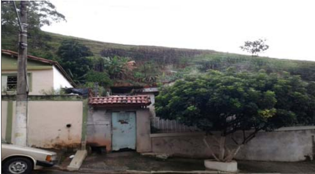
Foto: 1649876718155.jpg ID: 12 Moradia sujeita a risco de escorregamento, Talude de corte com solo exposto
