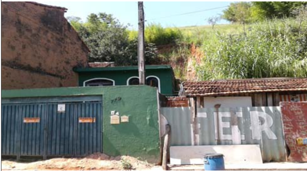
Foto: 1649868509526.jpg ID: 31 Formação de processo erosivo, Moradia sujeita a risco de escorregamento, Presença de cicatriz de escorregamento pretérito, Talude de corte com solo exposto
