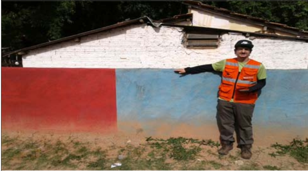
Foto: 1650371738106.jpg ID: 11 Detalhe para nível de atingimento
