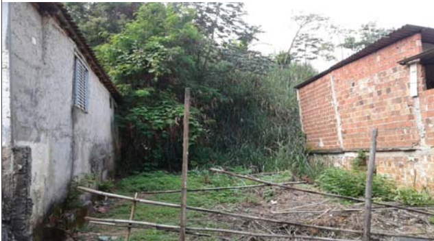
Foto: 1649856889475.jpg ID: 22 Formação de processo erosivo, Moradia sujeita a risco de escorregamento
