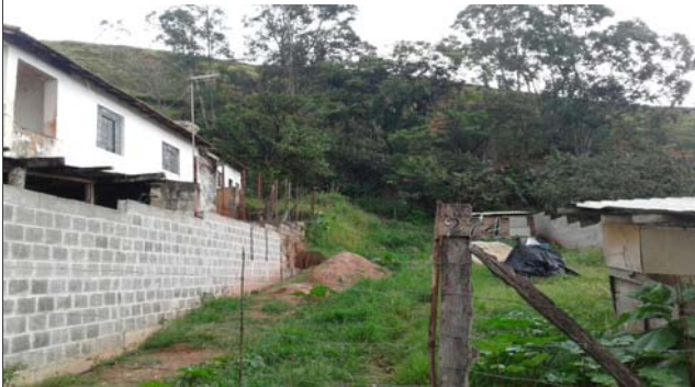
Foto: 1649877002917.jpg ID: 13 Depósito de escorregamento pretérito, Formação de processo erosivo, Moradia sujeita a risco de escorregamento, Presença de cicatriz de escorregamento pretérito
