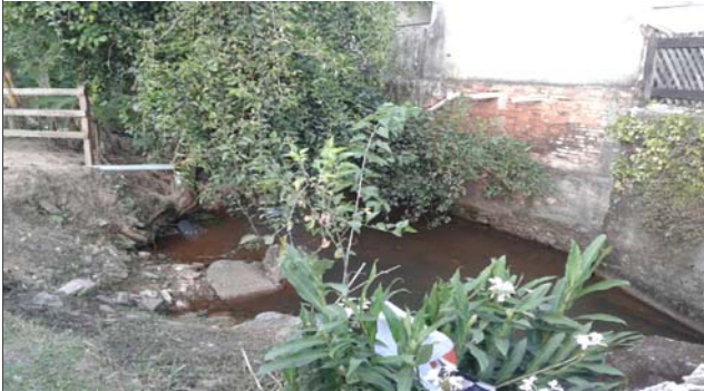
Foto: 1650916858007.jpg ID: 22 Visão geral da área, Visão geral da drenagem, Detalhe do canal
