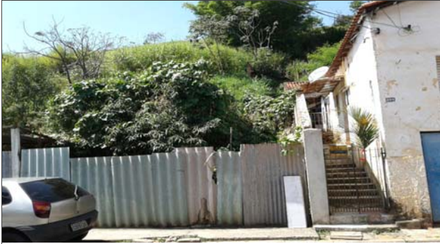
Foto: 1649868607274.jpg ID: 23 Moradia sujeita a risco de escorregamento
