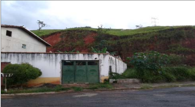
Foto: 1649879652526.jpg ID: 11 Talude de corte com solo exposto
