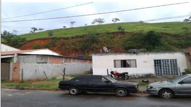
Foto: 1649879960950.jpg ID: 12 Talude de corte com solo exposto
