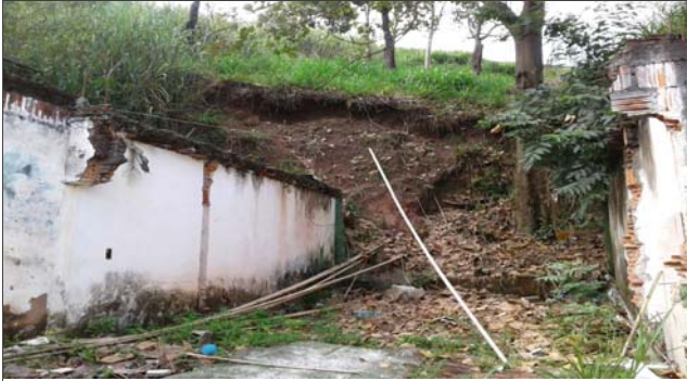
Foto: 1649856723249.jpg ID: 21 Formação de processo erosivo, Moradia sujeita a risco de escorregamento, Presença de cicatriz de escorregamento pretérito, Talude de corte com solo exposto
