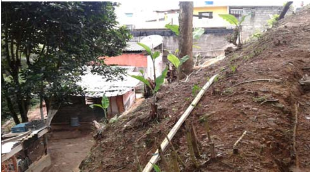
Foto: 1647615495282.jpg ID: 32 Talude de corte com solo exposto
