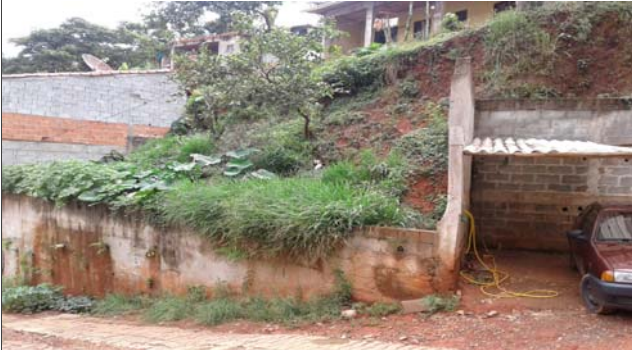
Foto: 1647883072957.jpg ID: 22 Talude de corte com solo exposto
