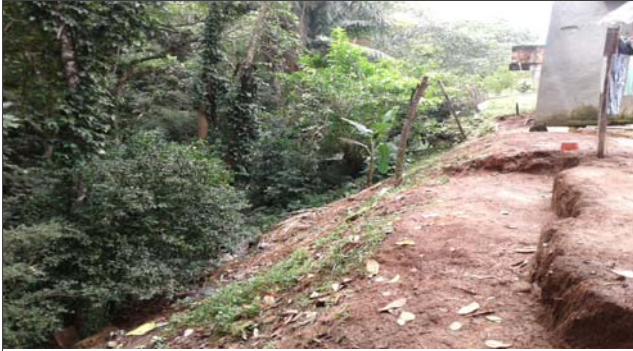
Foto: 1647615401714.jpg ID: 31 Formação de processo erosivo, Moradia sujeita a risco de escorregamento
