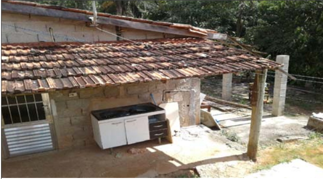
Foto: 1642526942795.jpg ID: 51 Visão geral do setor, Moradia sujeita a risco de escorregamento
