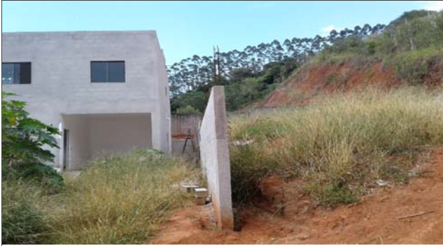
Foto: 1642611466501.jpg ID: 81 Formação de processo erosivo, Talude de corte com solo exposto
