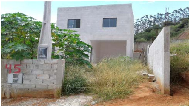
Foto: 1642611571930.jpg ID: 82 Moradia sujeita a risco de escorregamento
