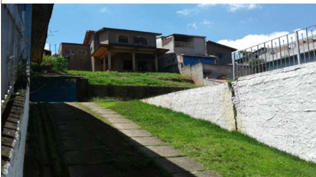
Foto: 1642595421247.jpg ID: 83 Detalhe para intervenção estrutural realizada para mitigação do risco, Talude de corte com solo exposto
