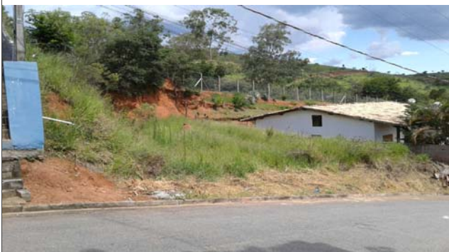
Foto: 1642610166776.jpg ID: 63 Moradia sujeita a risco de escorregamento, Talude de corte com solo exposto
