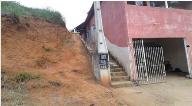
Foto: 1642609569013.jpg ID: 62 Talude de corte com solo exposto
