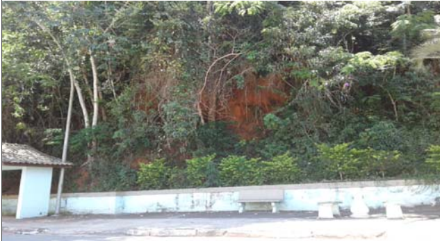
Foto: 1642606496247.jpg ID: 62 Presença de cicatriz de escorregamento pretérito
