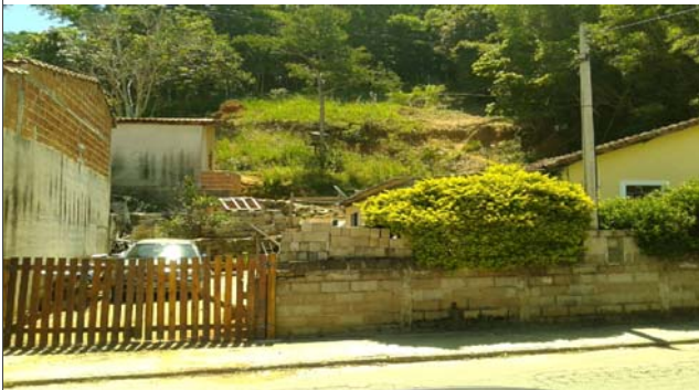
Foto: 1642606187945.jpg ID: 53 Moradia sujeita a risco de escorregamento, Talude de corte com solo exposto
