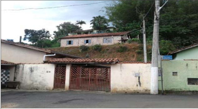
Foto: 1642613431858.jpg ID: 31 Visão geral do setor Talude de corte com solo exposto
