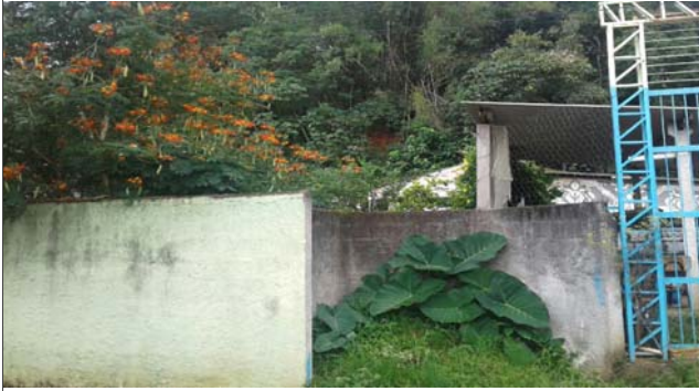
Foto: 1642614347146.jpg ID: 42 Presença de cicatriz de escorregamento pretérito
