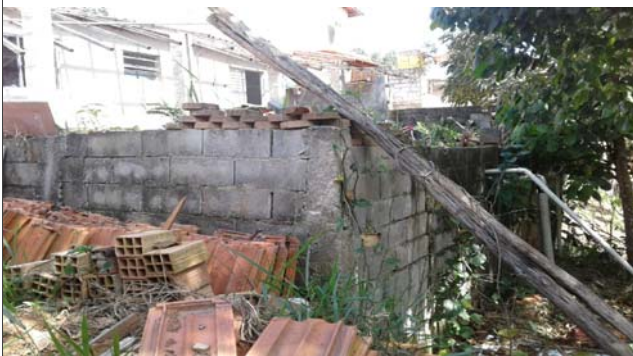
Foto: 1642527181883.jpg ID: 53 Evidência de movimentação em estruturas, Talude de aterro
