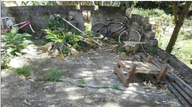
Foto: 1642527073291.jpg ID: 52 Evidência de movimentação em estruturas, Evidência de movimentação no terreno
