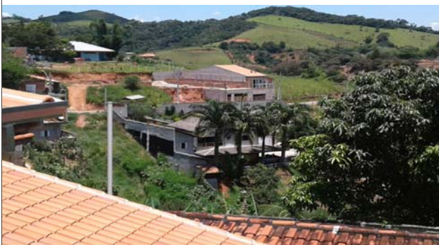
Foto: 1642600077406.jpg ID: 53 Visão geral do setor, Formação de processo erosivo, Talude de corte com solo exposto
