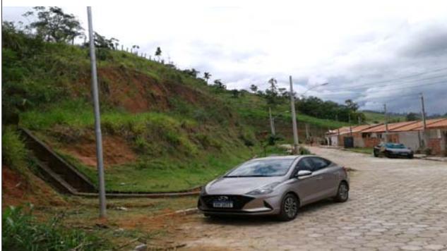
Foto: 1638884866642.jpg ID: 12 Talude de corte com solo exposto
