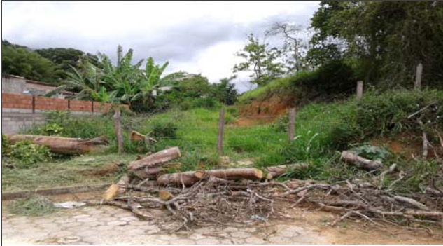
Foto: 1638884829478.jpg ID: 11 Talude de corte com solo exposto
