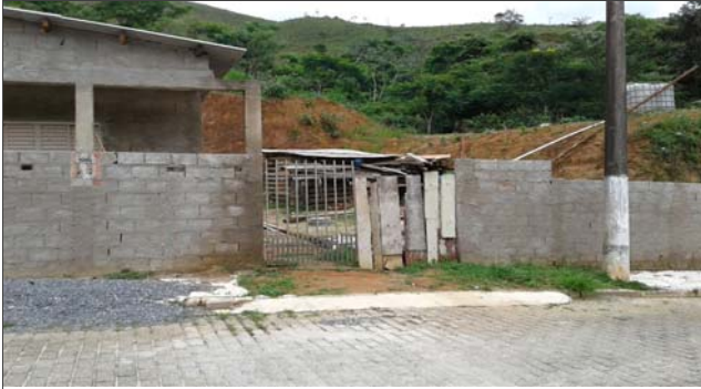
Foto: 1638967663905.jpg ID: 11 Formação de processo erosivo, Talude de corte com solo exposto
