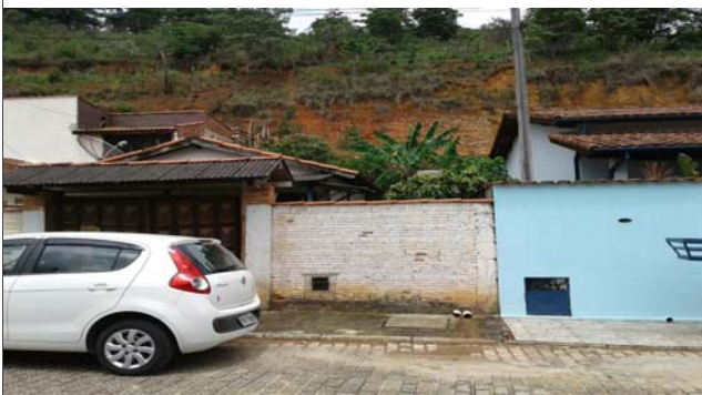
Foto: 1638968319985.jpg ID: 13 Visão geral do setor, Talude de corte com solo exposto
