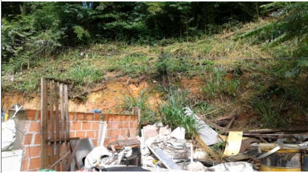
Foto: 1638898978753.jpg ID: 52 Formação de processo erosivo, Talude de corte com solo exposto
