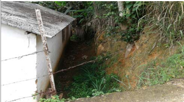
Foto: 1638984546316.jpg ID: 63 Talude de corte com solo exposto
