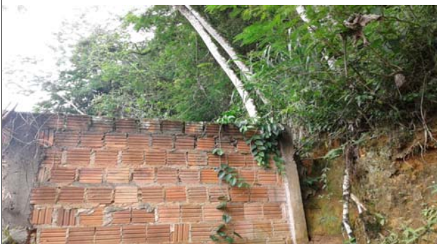
Foto: 1638980547338.jpg ID: 43 Talude de corte com solo exposto
