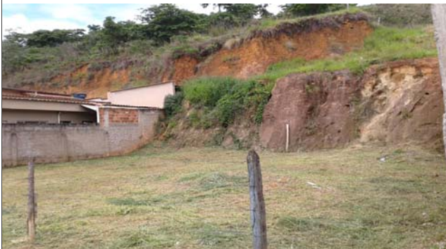
Foto: 1638967696755.jpg ID: 12 Talude de corte com solo exposto
