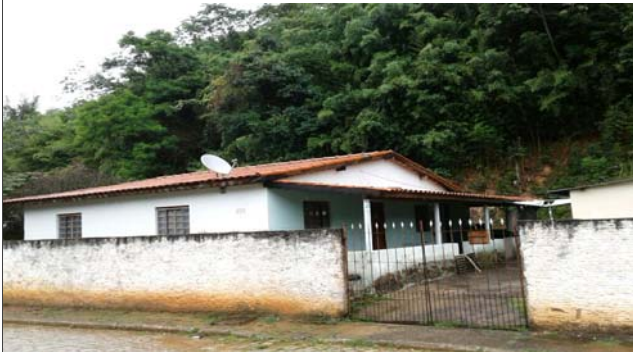
Foto: 1638894847356.jpg ID: 32 Formação de processo erosivo, Moradia sujeita a risco de escorregamento
