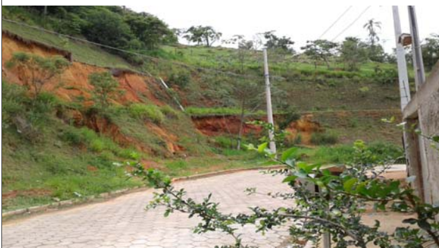
Foto: 1638884904690.jpg ID: 13 Formação de processo erosivo, Talude de corte com solo exposto
