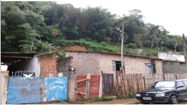
Foto: 1638896170455.jpg ID: 33 Moradia sujeita a risco de escorregamento, Talude de corte com solo exposto
