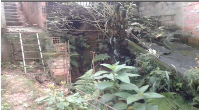
Foto: 1639049309862.jpg ID: 11 Detalhe para processo de ravinamento, Presença de cicatriz de escorregamento pretérito, Lançamento de águas/esgoto na superfície, Moradia sujeita a processos de erosão
