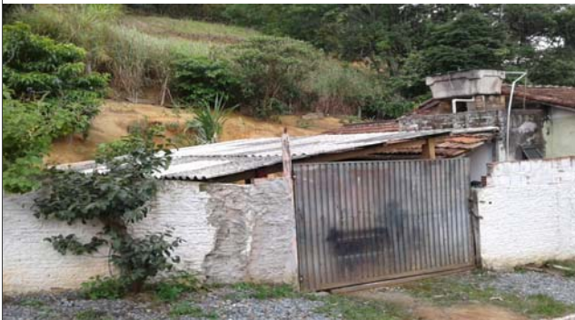
Foto: 1638817511373.jpg ID: 13 Talude de corte com solo exposto
