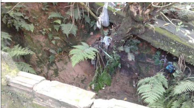
Foto: 1639049470287.jpg ID: 12 Detalhe para processo de erosão, Formação de processo erosivo
