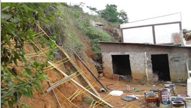
Foto: 1638968661261.jpg ID: 14 Formação de processo erosivo, Moradia sujeita a risco de escorregamento, Talude de corte com solo exposto
