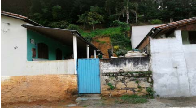
Foto: 1638896273239.jpg ID: 41 Talude de corte com solo exposto
