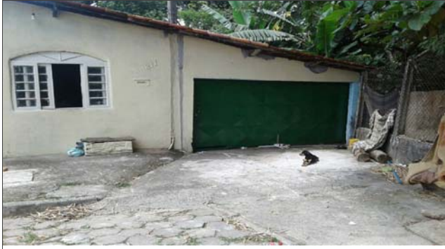
Foto: 1638447558553.jpg ID: 21 Visão geral do setor, Evidência de movimentação no terreno, Moradia sujeita a risco de solapamento
