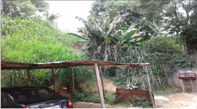
Foto: 1638540482994.jpg ID: 11 Formação de processo erosivo, Presença de cicatriz de escorregamento pretérito
