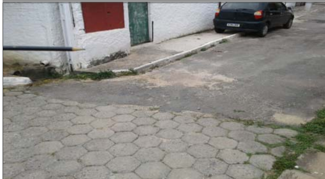
Foto: 1638529251079.jpg ID: 11 Imóveis afetados pelo processo
