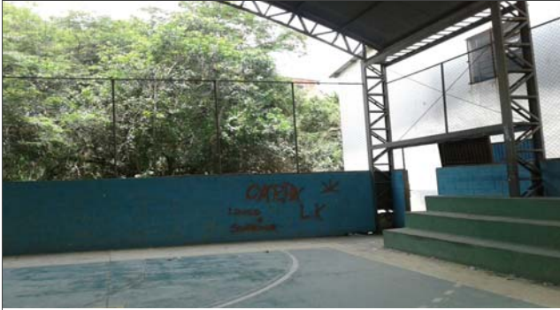
Foto: 1638537476775.jpg ID: 11 Formação de processo erosivo
