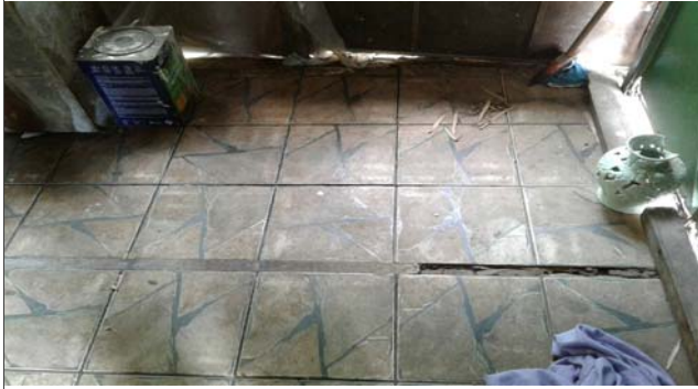
Foto: 1638447958614.jpg ID: 22 Evidência de movimentação no terreno
