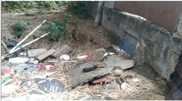
Foto: 1638447997475.jpg ID: 23 Detalhe para processo de solapamento no talude
