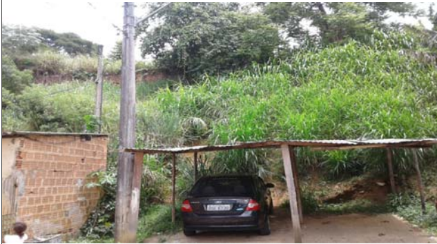
Foto: 1638540542195.jpg ID: 12 Formação de processo erosivo, Moradia sujeita a risco de escorregamento, Presença de cicatriz de escorregamento pretérito, Talude de corte com solo exposto
