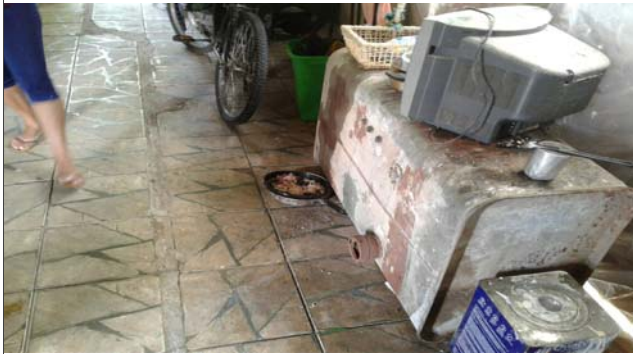
Foto: 1638448092357.jpg ID: 24 Evidência de movimentação no terreno
