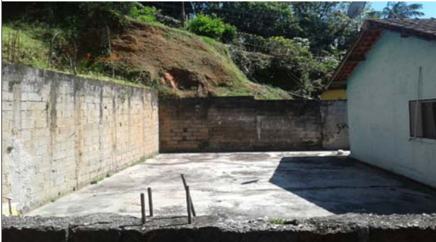
Foto: 1642768426413.jpg ID: 23 Presença de cicatriz de escorregamento pretérito
