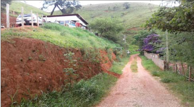
Foto: 1643224329063.jpg ID: 21 Visão geral do setor, Talude de corte com solo exposto
