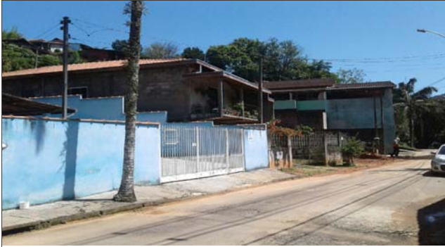
Foto: 1642768269924.jpg ID: 21 Visão geral do setor Moradia sujeita a risco de escorregamento
