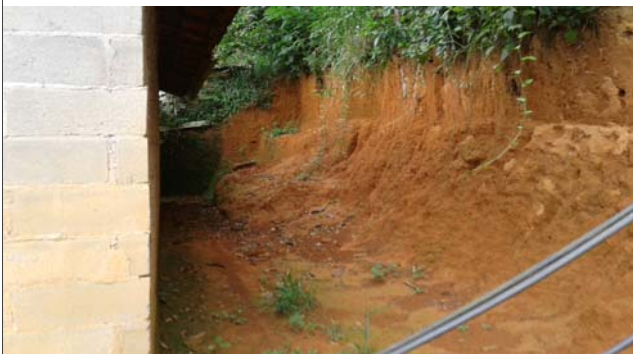
Foto: 1643371944514.jpg ID: 14 Talude de corte com solo exposto
