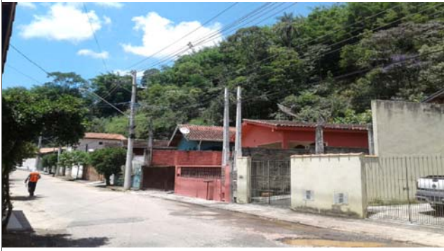
Foto: 1642771595948.jpg ID: 32 Formação de processo erosivo, Talude natural
