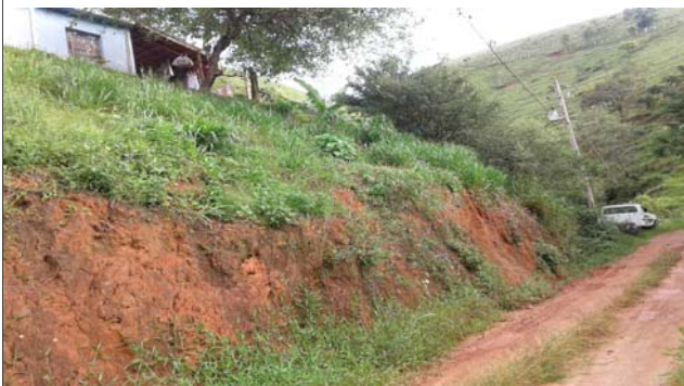
Foto: 1643224543977.jpg ID: 22 Formação de processo erosivo, Talude de corte com solo exposto
