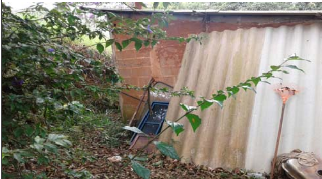
Foto: 1643370639748.jpg ID: 13 Talude de corte com solo exposto
