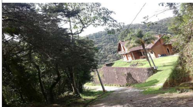
Foto: 1643215936897.jpg ID: 13 Visão geral do setor, Moradia sujeita a risco de escorregamento
