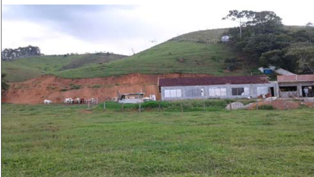
Foto: 1643309139406.jpg ID: 23 Visão geral do setor, Formação de processo erosivo, Talude de corte com solo exposto
