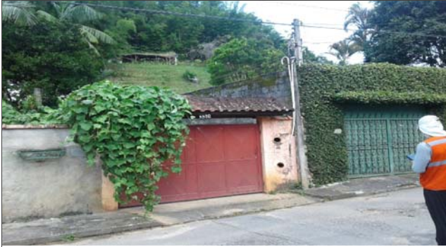
Foto: 1642771068334.jpg ID: 51 Visão geral do setor, Moradia sujeita a risco de escorregamento
