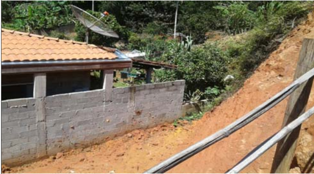
Foto: 1642768347827.jpg ID: 22 Talude de corte com solo exposto Presença de cicatriz de escorregamento pretérito
