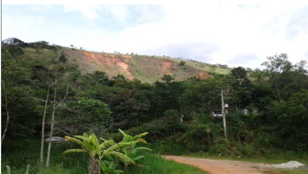
Foto: 1643366693803.jpg ID: 13 Visão geral do setor, Depósito de escorregamento pretérito, Formação de processo erosivo, Presença de cicatriz de escorregamento pretérito
