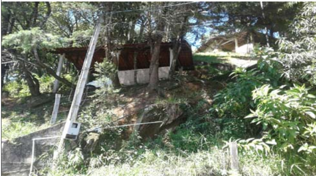
Foto: 1642768525208.jpg ID: 24 Formação de processo erosivo Presença de cicatriz de escorregamento pretérito
