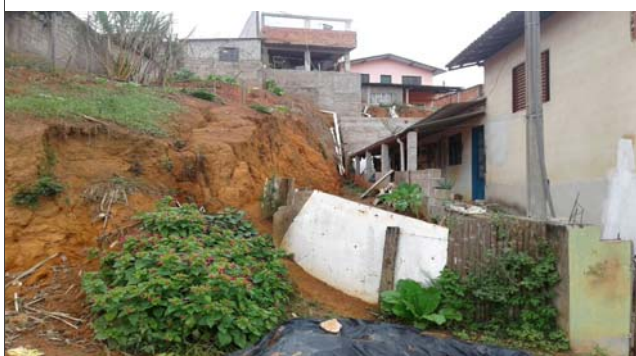
Foto: 1654786870546.jpg ID: 13 Formação de processo erosivo, Lançamento de águas/esgoto na superfície, Moradia sujeita a risco de escorregamento, Presença de cicatriz de escorregamento pretérito, Talude de corte com solo exposto
