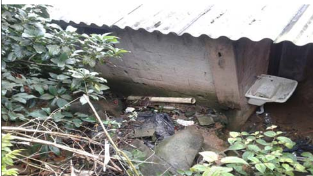
Foto: 1654699911042.jpg ID: 15 Depósito de escorregamento pretérito, Moradia sujeita a risco de escorregamento, Talude de corte com solo exposto
