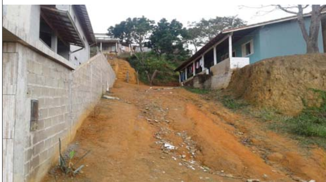
Foto: 1654787555717.jpg ID: 15 Formação de processo erosivo, Moradia sujeita a risco de escorregamento, Presença de cicatriz de escorregamento pretérito, Talude de corte com solo exposto
