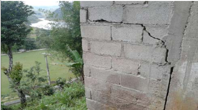
Foto: 1654698939328.jpg ID: 12 Evidência de movimentação em estruturas
