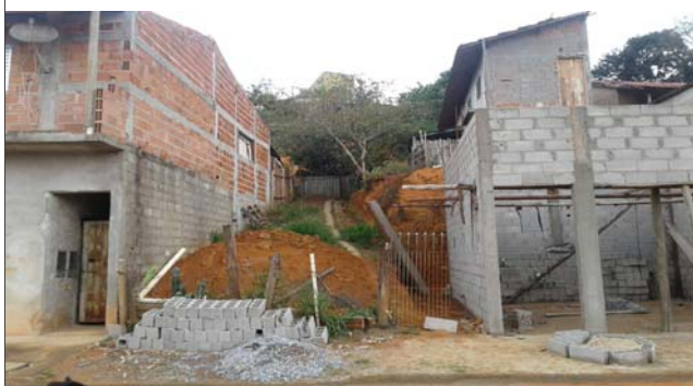
Foto: 1654787484495.jpg ID: 14 Formação de processo erosivo, Moradia sujeita a risco de escorregamento, Talude de corte com solo exposto
