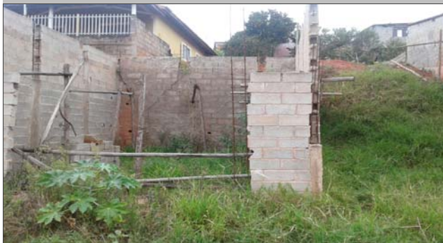
Foto: 1654786531585.jpg ID: 11 Evidência de movimentação em estruturas, Talude de corte com solo exposto
