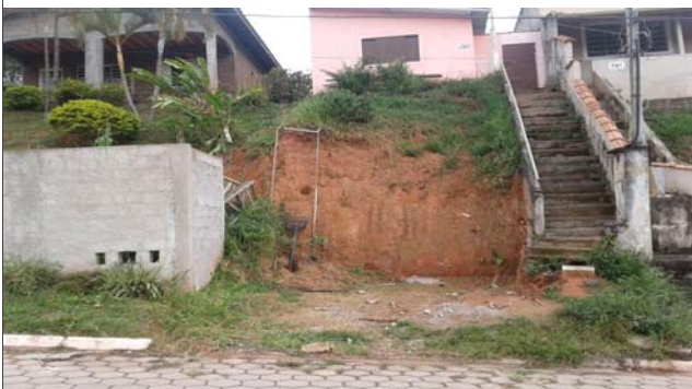
Foto: 1654784275045.jpg ID: 23 Talude de corte com solo exposto
