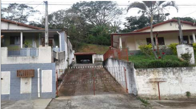
Foto: 1654783927074.jpg ID: 22 Talude de corte com solo exposto
