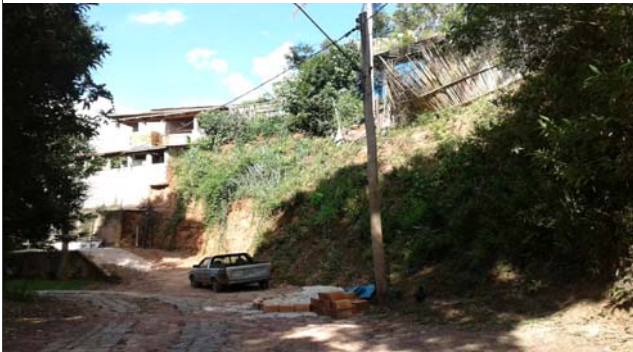
Foto: 1647540671439.jpg ID: 32 Talude de corte com solo exposto
