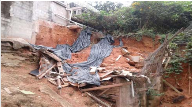
Foto: 1647281557520.jpg ID: 22 Depósito de escorregamento pretérito, Formação de processo erosivo, Moradia sujeita a risco de escorregamento, Presença de cicatriz de escorregamento pretérito, Talude de corte com solo exposto
