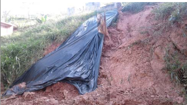
Foto: 1645728561529.jpg ID: 53 Evidência de movimentação no terreno, Formação de processo erosivo, Presença de cicatriz de escorregamento pretérito, Talude de corte com solo exposto
