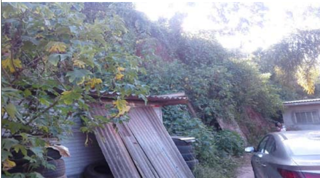
Foto: 1646854017526.jpg ID: 73 Moradia sujeita a risco de escorregamento, Presença de cicatriz de escorregamento pretérito, Talude de corte com solo exposto
