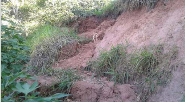
Foto: 1646853107942.jpg ID: 71 Depósito de escorregamento pretérito, Presença de cicatriz de escorregamento pretérito
