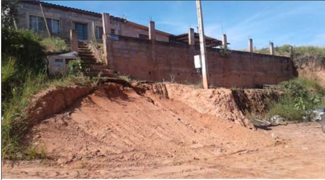
Foto: 1645791291829.jpg ID: 11 Visão geral do setor, Talude de corte com solo exposto
