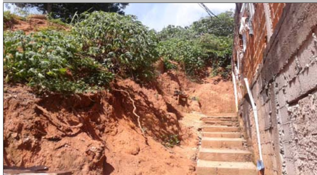
Foto: 1645794341755.jpg ID: 21 Talude de corte com solo exposto
