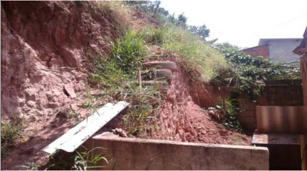
Foto: 1645712427593.jpg ID: 32 Depósito de escorregamento pretérito, Formação de processo erosivo, Moradia sujeita a risco de escorregamento, Presença de cicatriz de escorregamento pretérito, Talude de corte com solo exposto
