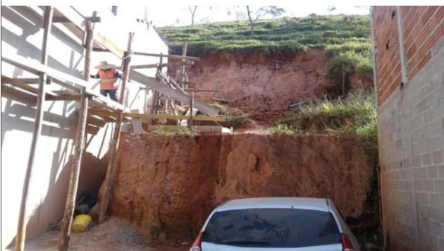
Foto: 1645728683199.jpg ID: 54 Formação de processo erosivo, Moradia sujeita a risco de escorregamento, Presença de cicatriz de escorregamento pretérito, Talude de corte com solo exposto
