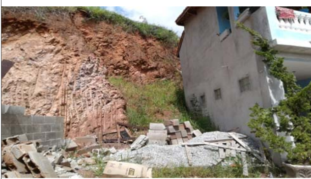
Foto: 1647266164828.jpg ID: 23 Talude de corte com solo exposto
