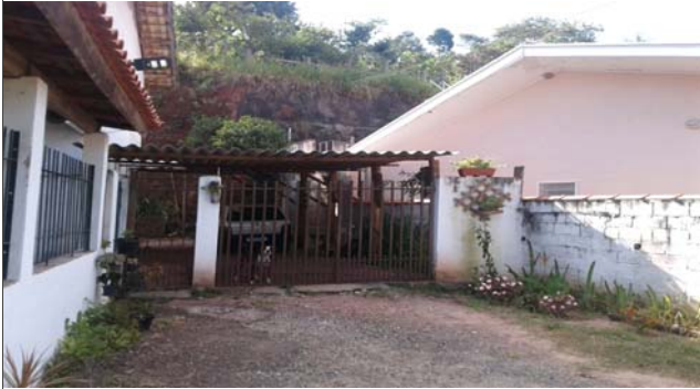
Foto: 1645641659577.jpg ID: 22 Talude de corte com solo exposto
