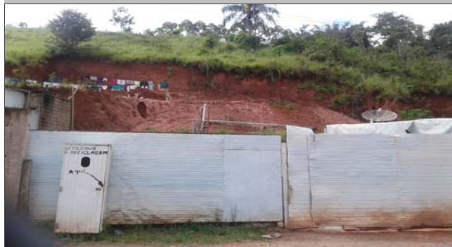
Foto: 1647349598573.jpg ID: 21 Formação de processo erosivo, Presença de cicatriz de escorregamento pretérito, Talude de corte com solo exposto
