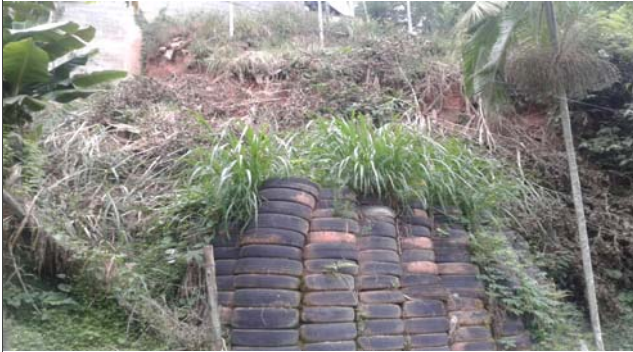
Foto: 1647285650834.jpg ID: 42 Depósito de escorregamento pretérito, Formação de processo erosivo, Moradia sujeita a risco de escorregamento, Presença de cicatriz de escorregamento pretérito, Talude de corte com solo exposto
