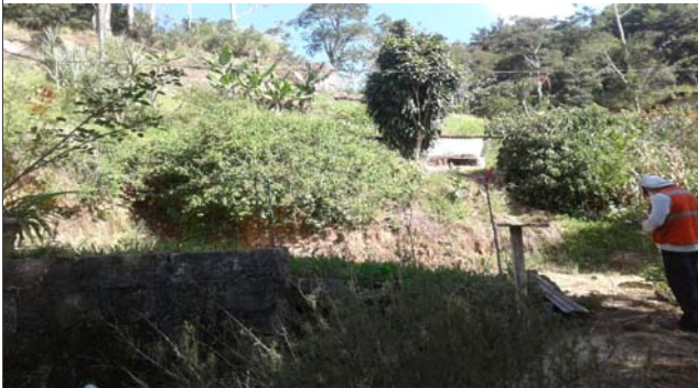
Foto: 1646936360904.jpg ID: 32 Presença de matações no topo do talude
