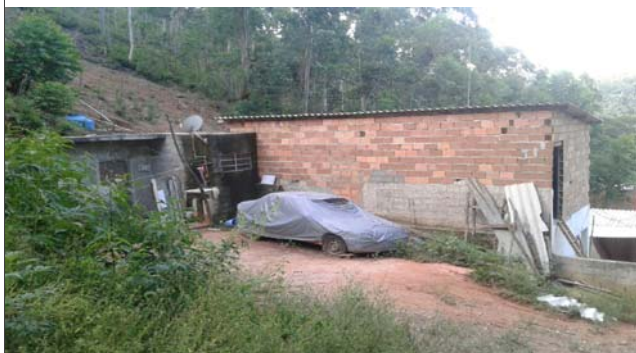
Foto: 1646767525986.jpg ID: 12 Visão geral do setor, Moradia sujeita a risco de escorregamento
