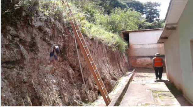
Foto: 1647534237754.jpg ID: 21 Talude de corte com solo exposto
