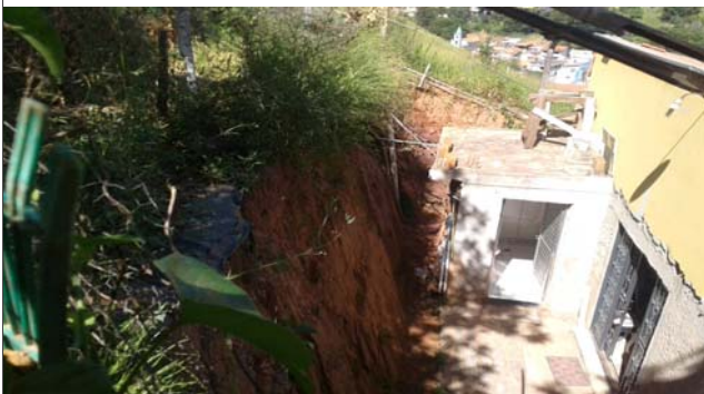
Foto: 1645792949627.jpg ID: 14 Formação de processo erosivo, Moradia sujeita a risco de escorregamento, Presença de cicatriz de escorregamento pretérito, Talude de corte com solo exposto
