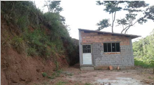
Foto: 1646939628799.jpg ID: 42 Talude de corte com solo exposto
