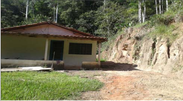
Foto: 1646936222192.jpg ID: 31 Moradia sujeita a risco de escorregamento, Talude de corte com solo exposto
