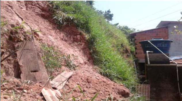
Foto: 1645712481554.jpg ID: 33 Depósito de escorregamento pretérito, Formação de processo erosivo, Moradia sujeita a risco de escorregamento, Presença de cicatriz de escorregamento pretérito, Talude de corte com solo exposto
