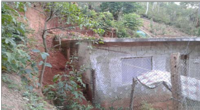
Foto: 1646767318389.jpg ID: 11 Depósito de escorregamento pretérito, Moradia sujeita a risco de escorregamento, Presença de cicatriz de escorregamento pretérito
