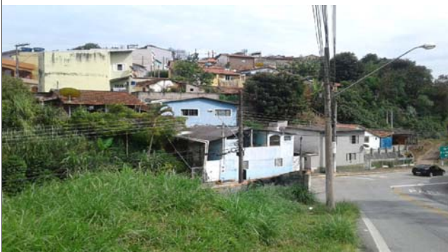
Foto: 1647002666198.jpg ID: 23 Visão geral do setor, Moradia sujeita a risco de escorregamento
