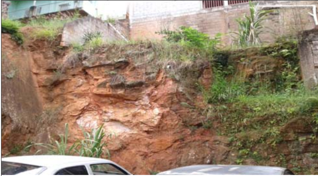
Foto: 1647275181418.jpg ID: 11 Talude de corte com solo exposto
