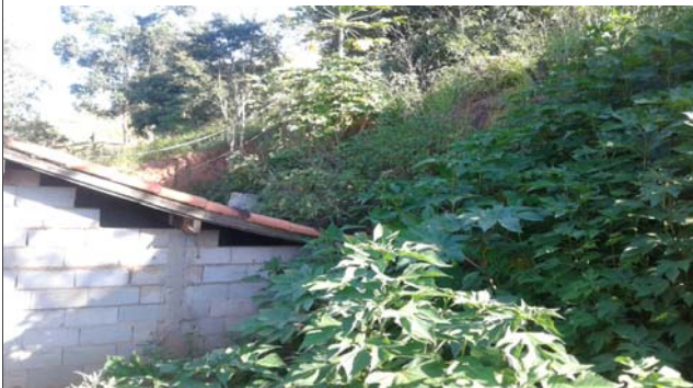
Foto: 1646853320329.jpg ID: 72 Talude de corte com solo exposto
