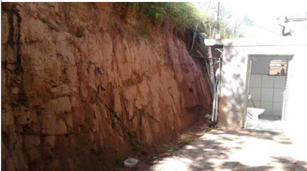
Foto: 1645792559782.jpg ID: 13 Formação de processo erosivo, Moradia sujeita a risco de escorregamento, Presença de cicatriz de escorregamento pretérito, Talude de corte com solo exposto
