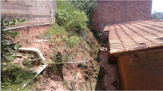
Foto: 1645722924037.jpg ID: 42 Talude de corte com solo exposto
