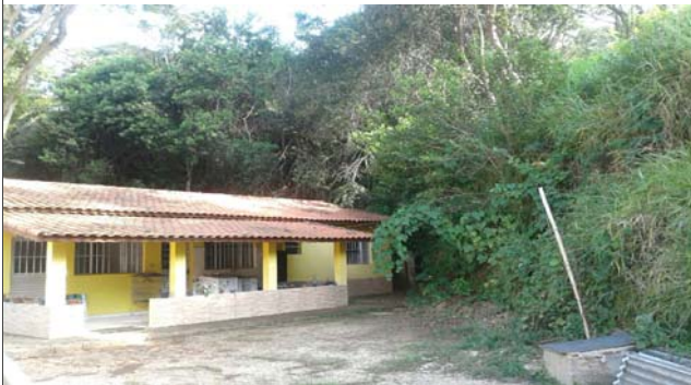
Foto: 1646764630135.jpg ID: 23 Formação de processo erosivo, Moradia sujeita a risco de escorregamento, Talude de corte com solo exposto
