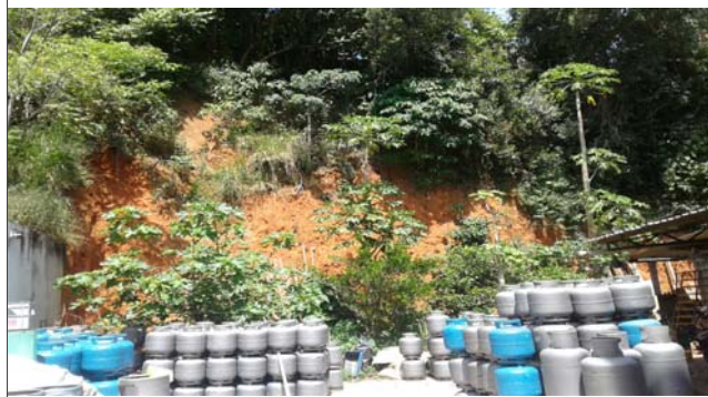
Foto: 1645796954864.jpg ID: 25 Formação de processo erosivo, Presença de cicatriz de escorregamento pretérito, Talude de corte com solo exposto
