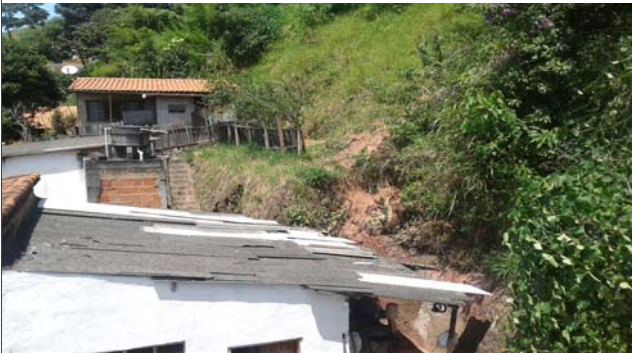
Foto: 1645712754003.jpg ID: 34 Depósito de escorregamento pretérito, Formação de processo erosivo, Moradia sujeita a risco de escorregamento, Presença de cicatriz de escorregamento pretérito, Talude de corte com solo exposto
