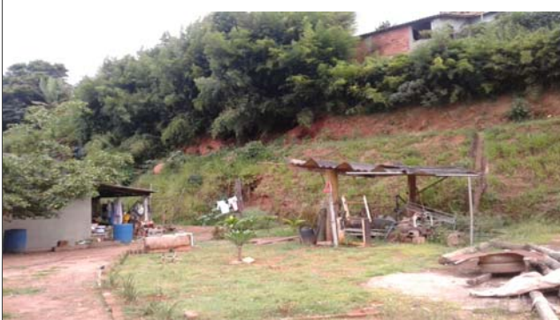
Foto: 1647364493581.jpg ID: 33 Formação de processo erosivo, Moradia sujeita a risco de escorregamento, Presença de cicatriz de escorregamento pretérito, Talude de corte com solo exposto
