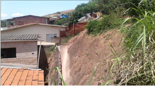
Foto: 1645722897079.jpg ID: 41 Talude de corte com solo exposto
