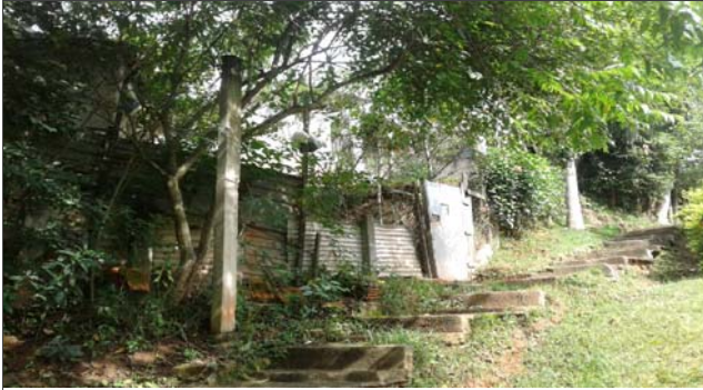
Foto: 1647001227977.jpg ID: 21 Visão geral do setor, Moradia sujeita a risco de escorregamento
