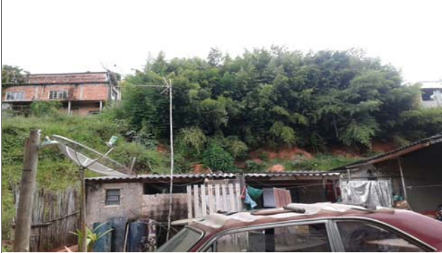
Foto: 1647364389843.jpg ID: 32 Depósito de escorregamento pretérito, Formação de processo erosivo, Moradia sujeita a risco de escorregamento, Presença de cicatriz de escorregamento pretérito, Talude de corte com solo exposto
