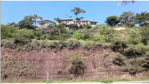
Foto: 1647523191767.jpg ID: 22 Visão geral do setor, Talude de corte com solo exposto
