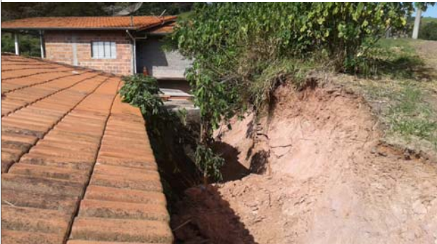
Foto: 1645725306669.jpg ID: 52 Depósito de escorregamento pretérito, Formação de processo erosivo, Moradia sujeita a risco de escorregamento, Presença de cicatriz de escorregamento pretérito, Talude de corte com solo exposto
