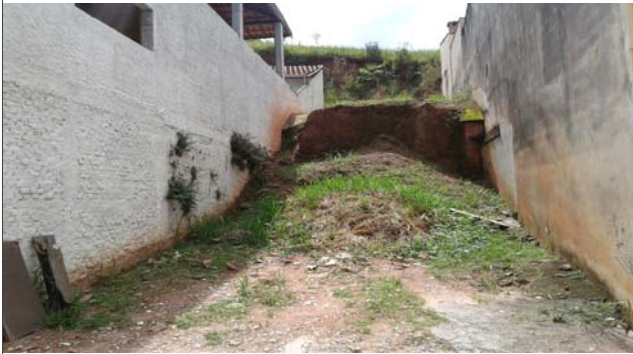
Foto: 1647362243976.jpg ID: 12 Formação de processo erosivo, Talude de corte com solo exposto
