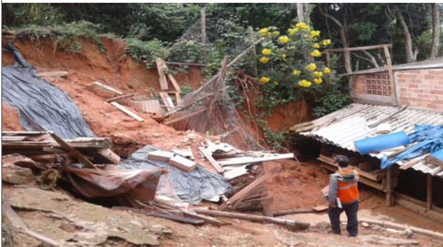
Foto: 1647281672949.jpg ID: 23 Depósito de escorregamento pretérito, Formação de processo erosivo, Moradia sujeita a risco de escorregamento, Presença de cicatriz de escorregamento pretérito, Talude de corte com solo exposto
