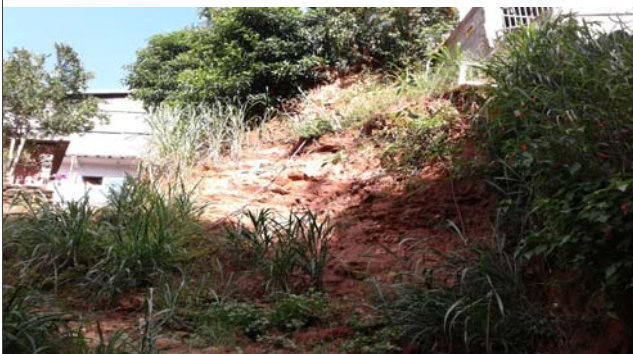
Foto: 1647541633489.jpg ID: 33 Moradia sujeita a risco de escorregamento, Presença de cicatriz de escorregamento pretérito, Talude de corte com solo exposto
