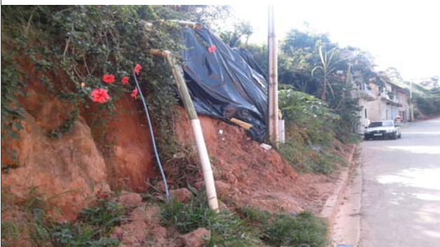
Foto: 1645728916856.jpg ID: 55 Formação de processo erosivo, Moradia sujeita a risco de escorregamento, Presença de cicatriz de escorregamento pretérito, Talude de corte com solo exposto
