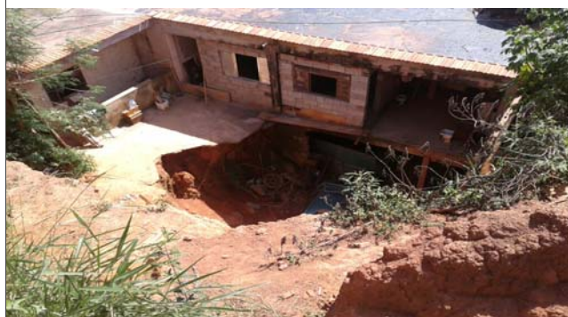
Foto: 1645795150726.jpg ID: 23 Evidência de movimentação no terreno, Formação de processo erosivo, Moradia sujeita a risco de escorregamento, Presença de cicatriz de escorregamento pretérito, Talude de corte com solo exposto
