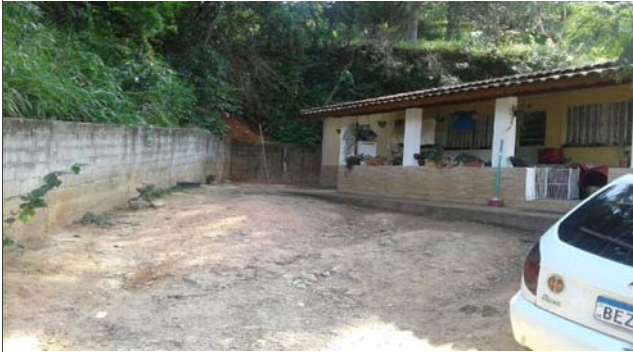
Foto: 1646764419342.jpg ID: 22 Formação de processo erosivo, Talude de corte com solo exposto
