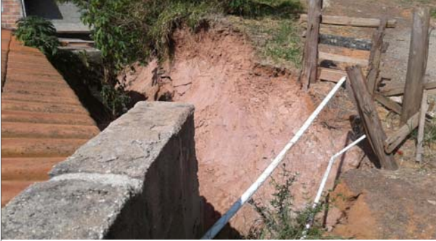
Foto: 1645725275787.jpg ID: 51 Formação de processo erosivo, Moradia sujeita a risco de escorregamento, Presença de cicatriz de escorregamento pretérito, Talude de corte com solo exposto
