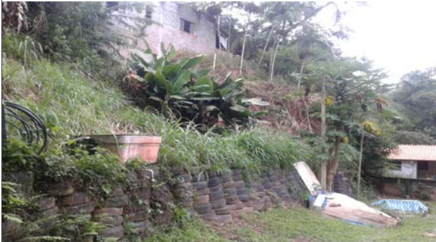
Foto: 1647286269695.jpg ID: 43 Depósito de escorregamento pretérito, Formação de processo erosivo, Moradia sujeita a risco de escorregamento, Presença de cicatriz de escorregamento pretérito, Talude de corte com solo exposto
