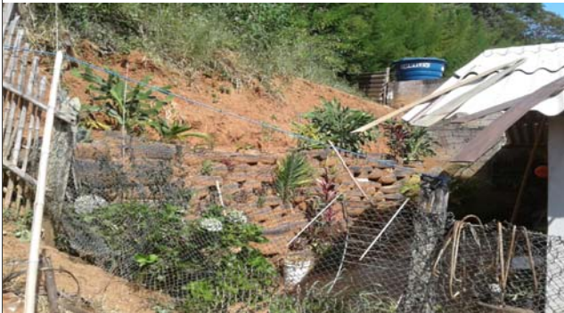
Foto: 1646678135776.jpg ID: 32 Talude de corte com solo exposto
