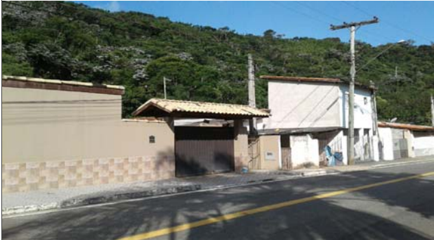
Foto: 1646679093031.jpg ID: 42 Visão geral do setor, Moradia sujeita a risco de escorregamento, Talude natural
