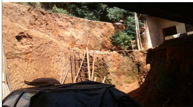
Foto: 1645795015466.jpg ID: 22 Formação de processo erosivo, Moradia sujeita a risco de escorregamento, Presença de cicatriz de escorregamento pretérito, Talude de corte com solo exposto
