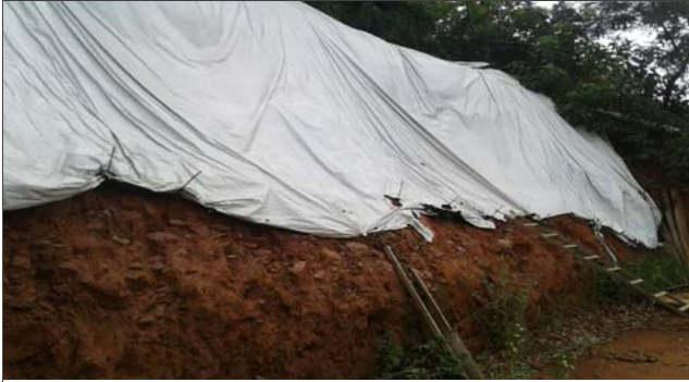
Foto: 1647006878527.jpg ID: 51 Presença de cicatriz de escorregamento pretérito, Talude de corte com solo exposto,
