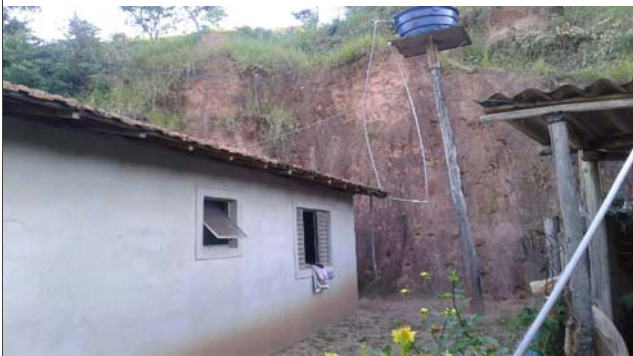
Foto: 1646854647124.jpg ID: 74 Moradia sujeita a risco de escorregamento, Talude de corte com solo exposto
