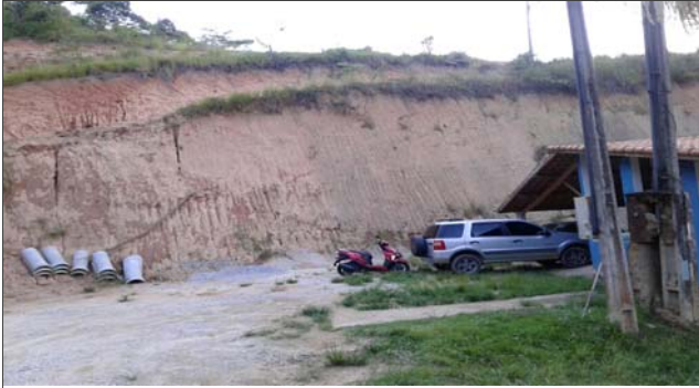
Foto: 1647546903961.jpg ID: 51 Visão geral do setor, Talude de corte com solo exposto
