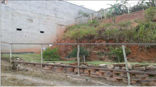
Foto: 1647361276514.jpg ID: 11 Talude de corte com solo exposto
