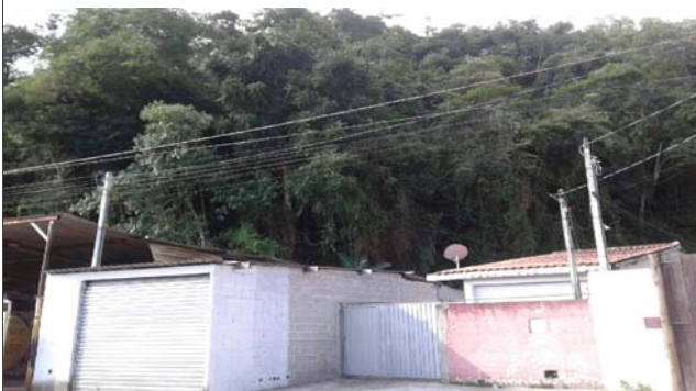
Foto: 1646679359308.jpg ID: 43 Depósito de escorregamento pretérito, Moradia sujeita a risco de escorregamento, Presença de cicatriz de escorregamento pretérito, Talude natural
