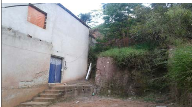
Foto: 1646770265288.jpg ID: 15 Talude de corte com solo exposto, Presença de estrutura desfavorável à segurança
