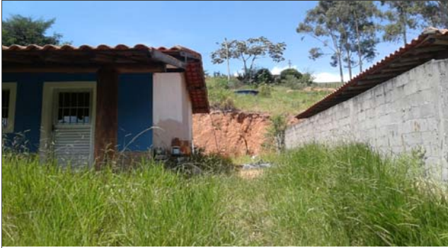
Foto: 1646750152108.jpg ID: 21 Moradia sujeita a risco de escorregamento, Talude de corte com solo exposto
