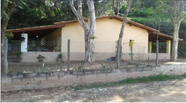
Foto: 1646764174248.jpg ID: 21 Moradia sujeita a risco de escorregamento
