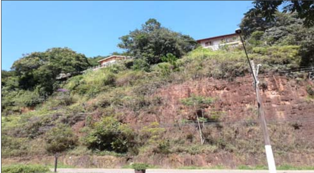
Foto: 1647522711481.jpg ID: 21 Visão geral do setor, Talude de corte com solo exposto
