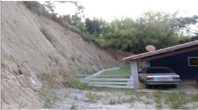
Foto: 1647547489285.jpg ID: 52 Talude de corte com solo exposto
