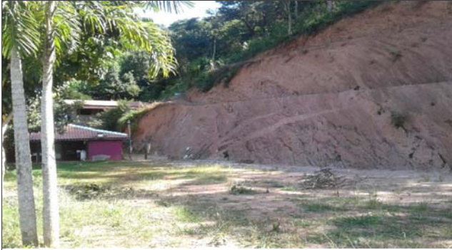
Foto: 1646934815045.jpg ID: 21 Talude de corte com solo exposto
