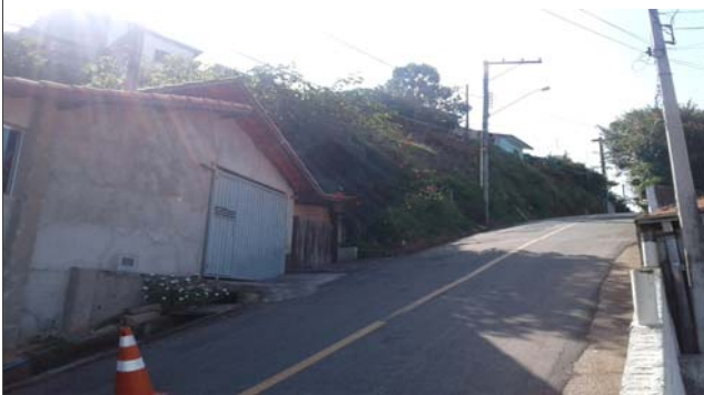
Foto: 1645727368030.jpg ID: 44 Talude de corte com solo exposto
