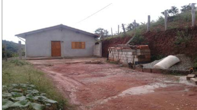
Foto: 1647350828023.jpg ID: 24 Formação de processo erosivo, Talude de corte com solo exposto
