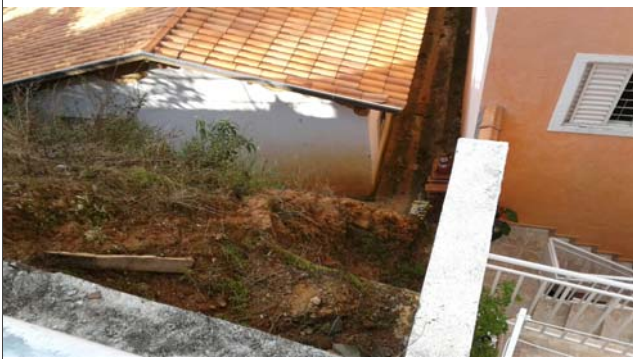
Foto: 1647544326616.jpg ID: 43 Talude de corte com solo exposto
