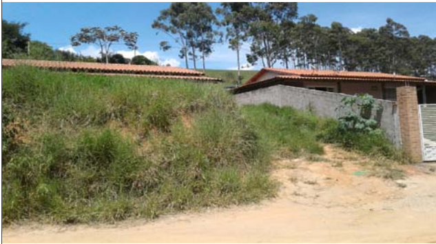
Foto: 1646750375143.jpg ID: 22 Visão geral do setor, Moradia sujeita a risco de escorregamento
