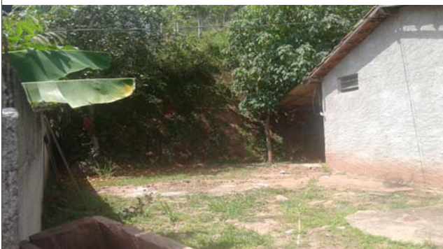
Foto: 1645710131012.jpg ID: 23 Talude de corte com solo exposto
