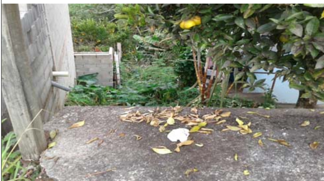
Foto: 1654799387700.jpg ID: 13 Lançamento de águas/esgoto na superfície
