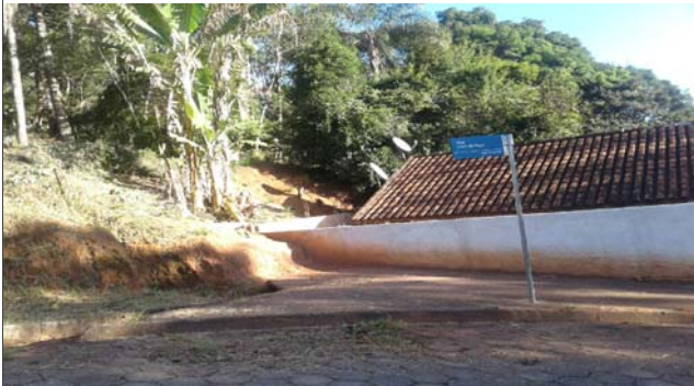
Foto: 1655233030598.jpg ID: 42 Formação de processo erosivo, Talude de corte com solo exposto
