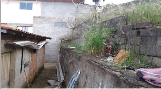
Foto: 1654797918261.jpg ID: 11 Evidência de movimentação em estruturas
