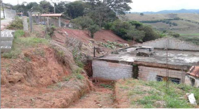
Foto: 1654802222534.jpg ID: 11 Formação de processo erosivo, Talude de corte com solo exposto
