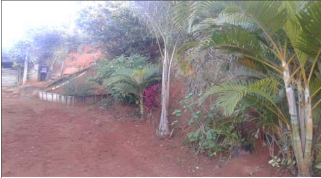
Foto: 1655143410882.jpg ID: 11 Formação de processo erosivo, Talude de corte com solo exposto
