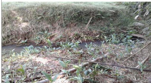
Foto: 1655127025599.jpg ID: 23 Detalhe do canal, Presença de cicatriz de escorregamento pretérito, Formação de processo erosivo
