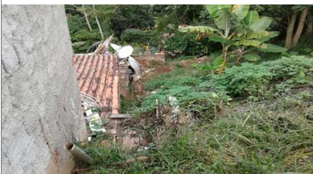
Foto: 1654799721780.jpg ID: 15 Moradia sujeita a risco de escorregamento, Talude de corte com solo exposto
