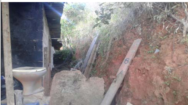
Foto: 1655143938378.jpg ID: 13 Formação de processo erosivo, Moradia sujeita a risco de escorregamento, Presença de cicatriz de escorregamento pretérito, Talude de corte com solo exposto
