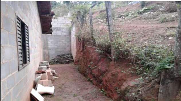
Foto: 1654804255382.jpg ID: 13 Formação de processo erosivo, Talude de corte com solo exposto
