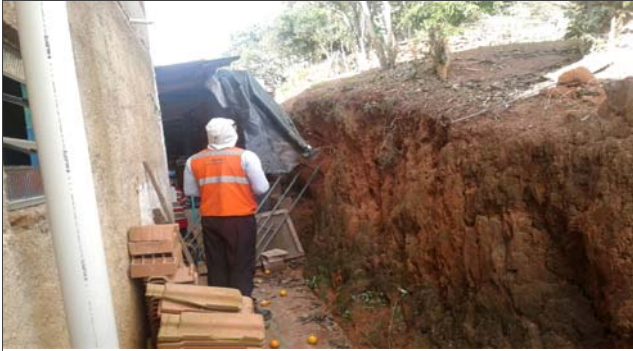
Foto: 1655225896520.jpg ID: 21 Formação de processo erosivo, Talude de corte com solo exposto
