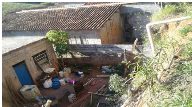
Foto: 1655230339048.jpg ID: 35 Evidência de movimentação no terreno, Formação de processo erosivo, Moradia sujeita a risco de escorregamento, Presença de cicatriz de escorregamento pretérito, Talude de corte com solo exposto
