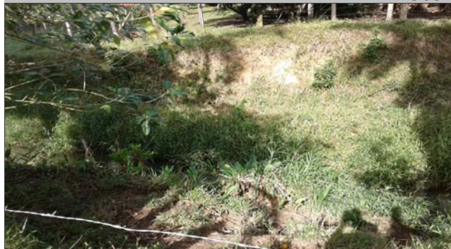
Foto: 1655126645739.jpg ID: 21 Detalhe do canal, Presença de cicatriz de escorregamento pretérito, Formação de processo erosivo
