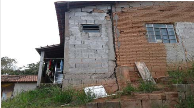
Foto: 1654798102250.jpg ID: 12 Evidência de movimentação em estruturas, Moradia sujeita a risco de escorregamento
