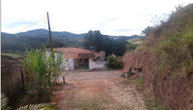
Foto: 1655226707879.jpg ID: 23 Formação de processo erosivo, Talude de corte com solo exposto
