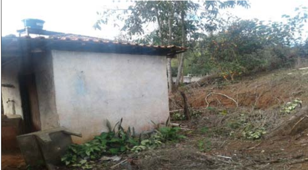
Foto: 1655226368172.jpg ID: 22 Formação de processo erosivo
