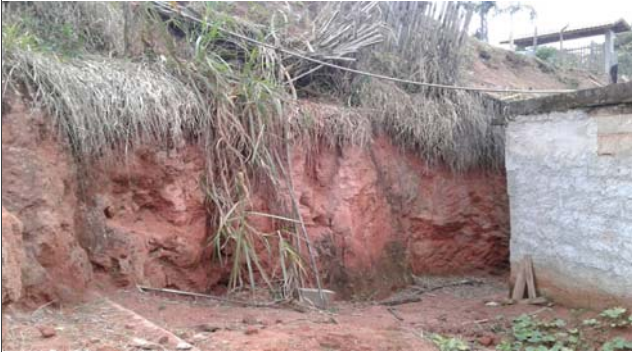
Foto: 1654803346945.jpg ID: 12 Formação de processo erosivo, Talude de corte com solo exposto
