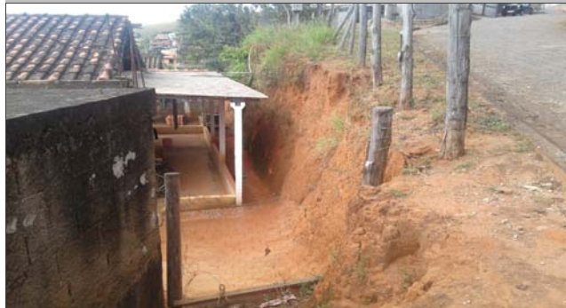
Foto: 1655228924999.jpg ID: 31 Evidência de movimentação no terreno, Formação de processo erosivo, Moradia sujeita a risco de escorregamento, Presença de cicatriz de escorregamento pretérito, Talude de corte com solo exposto
