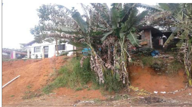
Foto: 1655229167426.jpg ID: 32 Evidência de movimentação no terreno, Formação de processo erosivo, Lançamento de águas/esgoto na superfície, Moradia sujeita a risco de escorregamento, Presença de vagamento de tubulação de água/esgoto, Talude de corte com solo exposto
