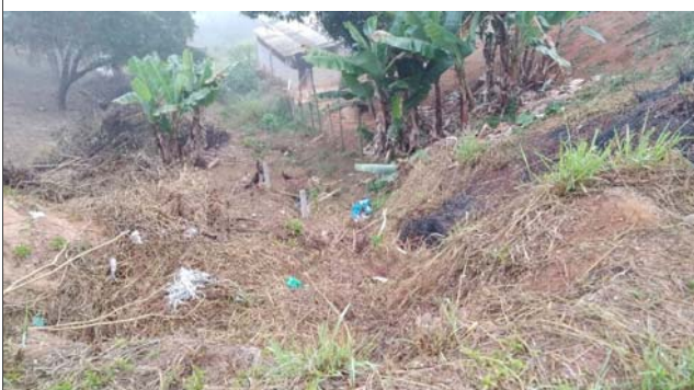
Foto: 1659355131739.jpg ID: 25 Formação de processo erosivo, Lançamento de águas/esgoto na superfície
