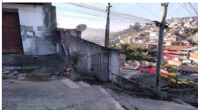
Foto: 1658749094020.jpg ID: 14 Evidência de movimentação em estruturas
