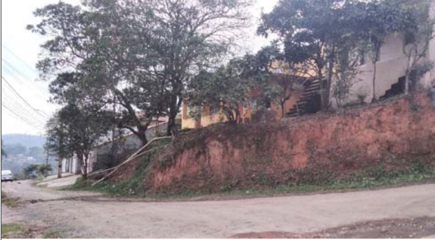
Foto: 1658931663775.jpg ID: 31 Visão geral do setor, Formação de processo erosivo, Talude de corte com solo exposto
