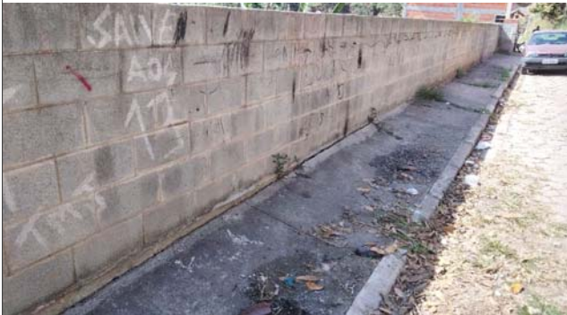
Foto: 1659358934001.jpg ID: 43 Evidência de movimentação em estruturas
