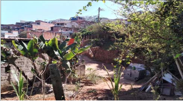
Foto: 1658762329040.jpg ID: 11 Talude de corte com solo exposto
