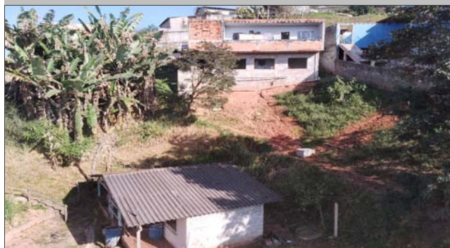
Foto: 1658838596221.jpg ID: 11 Visão geral do setor, Presença de árvore inclinada, Talude de corte com solo exposto
