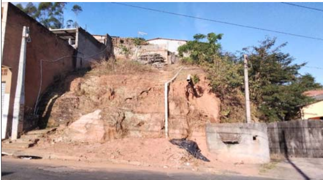
Foto: 1658775992691.jpg ID: 24 Formação de processo erosivo, Talude de corte com solo exposto
