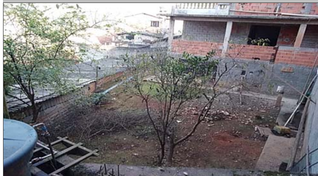
Foto: 1658748411773.jpg ID: 11 Visão geral do setor, Formação de processo erosivo, Lançamento de águas/esgoto na superfície, Moradia sujeita a risco de escorregamento
