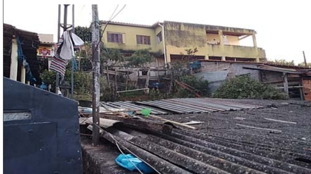
Foto: 1658748807464.jpg ID: 13 Moradia sujeita a risco de escorregamento, Talude de corte com solo exposto
