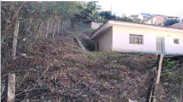
Foto: 1658769035475.jpg ID: 13 Moradia sujeita a risco de escorregamento, Talude de corte com solo exposto
