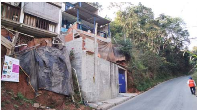
Foto: 1659011897924.jpg ID: 15 Depósito de escorregamento pretérito, Moradia sujeita a risco de escorregamento, Presença de cicatriz de escorregamento pretérito, Talude de corte com solo exposto
