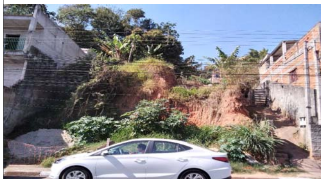
Foto: 1658243094758.jpg ID: 14 Talude de corte com solo exposto
