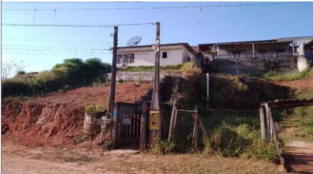
Foto: 1658859707260.jpg ID: 12 Talude de corte com solo exposto
