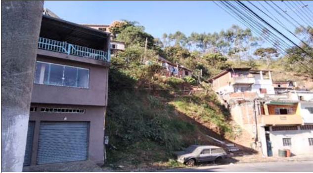
Foto: 1658774716245.jpg ID: 22 Visão geral do setor, Talude de corte com solo exposto
