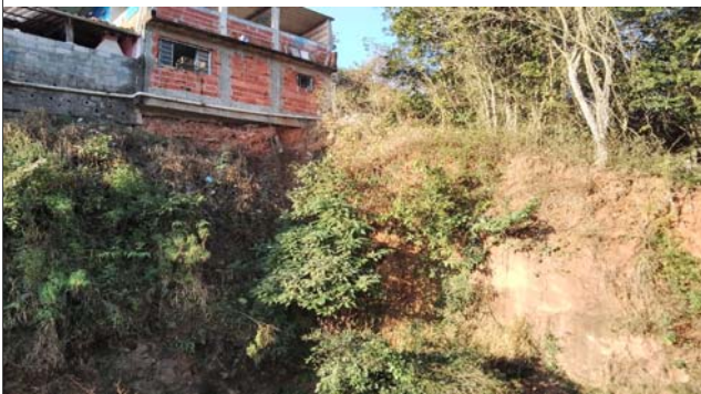
Foto: 165877599935.jpg ID: 25 Depósito de escorregamento pretérito, Evidência de movimentação em estruturas, Formação de processo erosivo, Moradia sujeita a risco de escorregamento, Presença de cicatriz de escorregamento pretérito, Talude de corte com solo exposto
