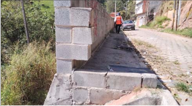
Foto: 1659020754384.jpg ID: 32 Evidência de movimentação em estruturas
