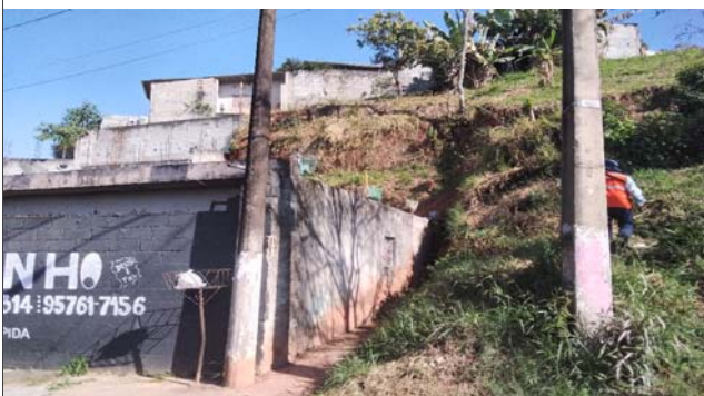
Foto: 1658848256491.jpg ID: 25 Moradia sujeita a risco de escorregamento, Talude de corte com solo exposto
