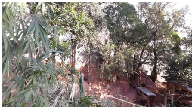
Foto: 1658244394304.jpg ID: 15 Evidência de movimentação em estruturas, Talude de corte com solo exposto
