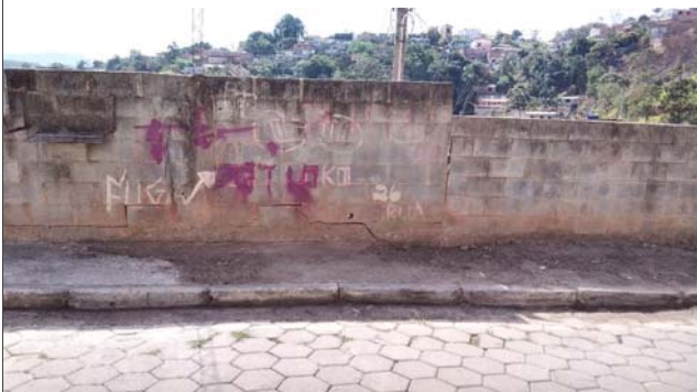
Foto: 1659359044956.jpg ID: 44 Evidência de movimentação em estruturas
