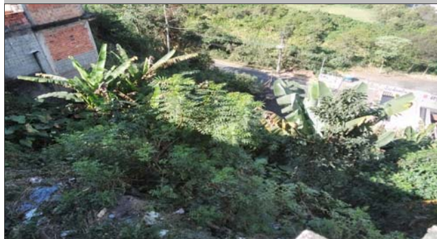
Foto: 1658335601160.jpg ID: 22 Depósito de escorregamento pretérito, Moradia sujeita a risco de escorregamento, Talude de corte com solo exposto
