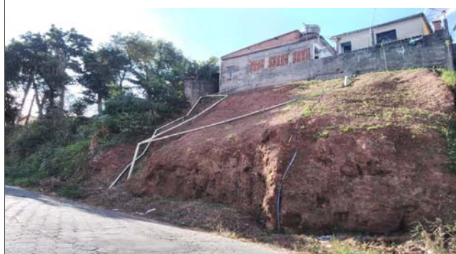
Foto: 1658345366728.jpg ID: 24 Formação de processo erosivo, Moradia sujeita a risco de escorregamento, Presença de árvore inclinada, Talude de corte com solo exposto
