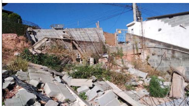
Foto: 1658254684388.jpg ID: 14 Depósito de escorregamento pretérito, Evidência de movimentação em estruturas, Evidência de movimentação no terreno, Formação de processo erosivo, Moradia sujeita a risco de escorregamento, Presença de cicatriz de escorregamento pretérito, Talude de corte
