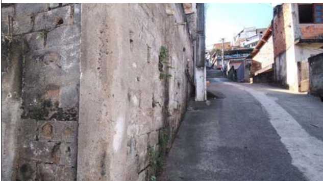
Foto: 1658769955729.jpg ID: 14 Evidência de movimentação em estruturas
