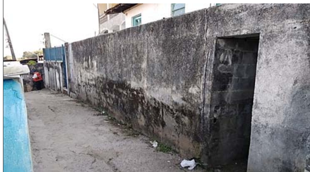
Foto: 1658748680031.jpg ID: 12 Evidência de movimentação em estruturas
