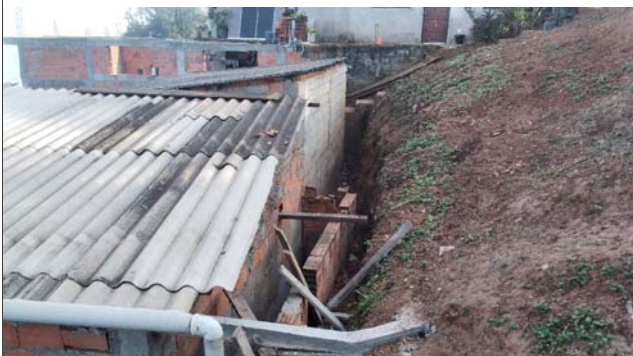
Foto: 1659007949123.jpg ID: 12 Moradia sujeita a risco de escorregamento, Talude de corte com solo exposto
