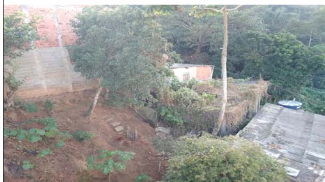
Foto: 1658749305992.jpg ID: 15 Talude de corte com solo exposto
