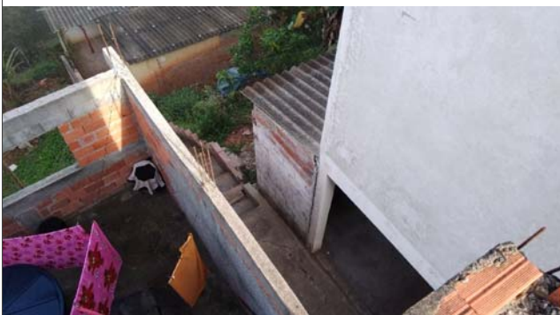
Foto: 1659008009617.jpg ID: 13 Evidência de movimentação em estruturas
