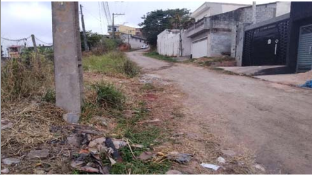
Foto: 1658931711407.jpg ID: 32 Detalhe para sistema de drenagem superficial, Lançamento de águas/esgoto na superfície
