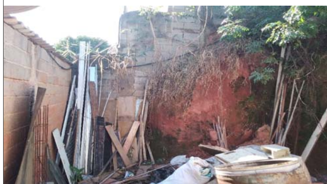
Foto: 1658325875747.jpg ID: 13 Evidência de movimentação em estruturas, Talude de corte com solo exposto
