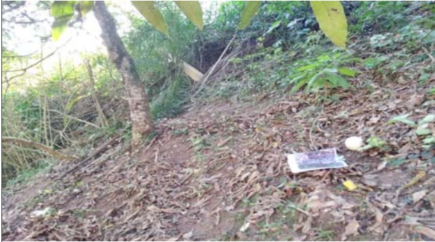
Foto: 1658774766085.jpg ID: 23 Evidência de movimentação no terreno, Presença de árvore inclinada
