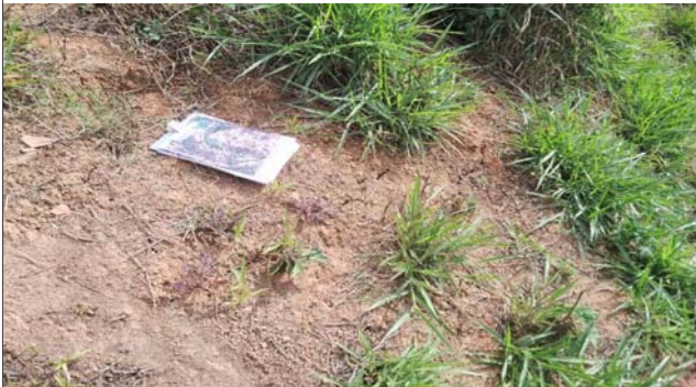
Foto: 1658926161330.jpg ID: 12 Evidência de movimentação no terreno
