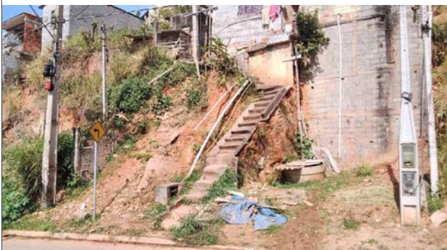
Foto: 1659021627457.jpg ID: 34 Formação de processo erosivo, Lançamento de águas/esgoto na superfície, Moradia sujeita a risco de escorregamento, Talude de corte com solo exposto
