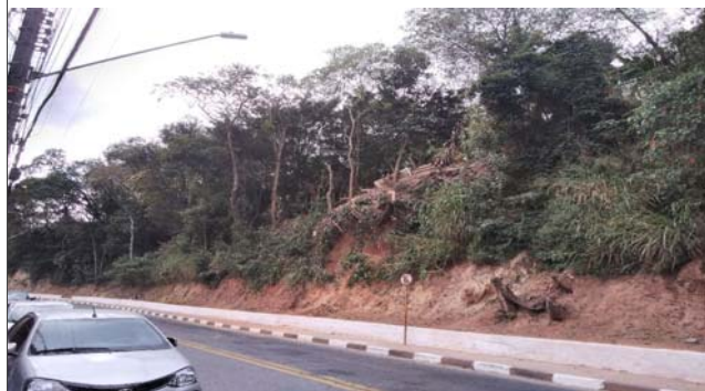
Foto: 1658326950389.jpg ID: 15 Depósito de escorregamento pretérito, Formação de processo erosivo, Presença de árvore inclinada, Presença de cicatriz de escorregamento pretérito, Talude de corte com solo exposto
