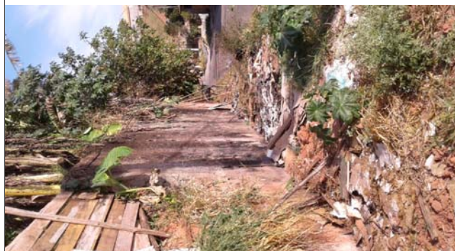
Foto: 1658243984499.jpg ID: 12 Evidência de movimentação em estruturas
