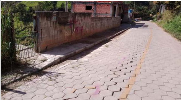
Foto: 1659021133619.jpg ID: 33 Evidência de movimentação em estruturas, Evidência de movimentação no terreno
