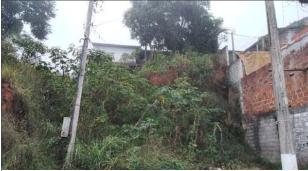
Foto: 1659354021275.jpg ID: 22 Talude de corte com solo exposto
