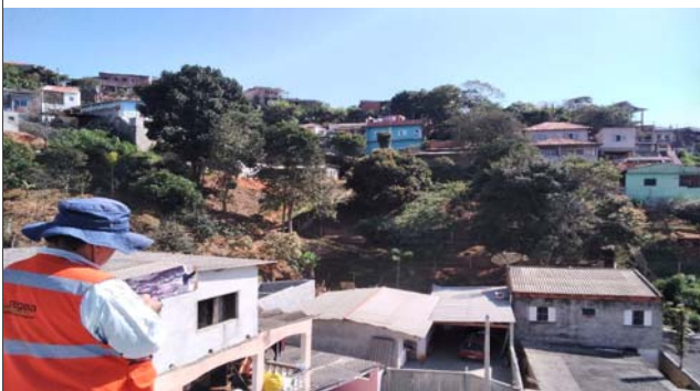
Foto: 1658848487737.jpg ID: 26 Talude de corte com solo exposto
