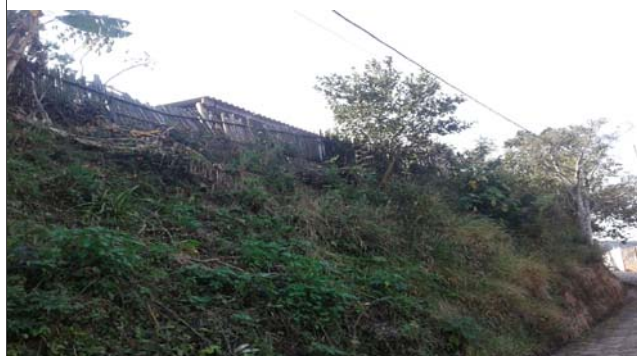
Foto: 1654191214373.jpg ID: 12 Evidência de movimentação em estruturas e no terreno, Formação de processo erosivo, Moradia sujeita a risco de escorregamento, Presença de árvore inclinada, Presença de cicatriz de escorregamento pretérito, Talude de corte com solo exposto
