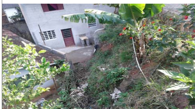
Foto: 1654191434694.jpg ID: 14 Evidência de movimentação no terreno, Formação de processo erosivo, Moradia sujeita a risco de escorregamento, Presença de cicatriz de escorregamento pretérito, Talude de corte com solo exposto
