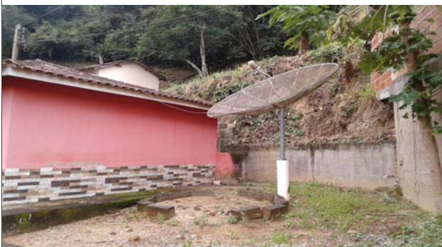
Foto: 1654093966899.jpg ID: 13 Formação de processo erosivo, Moradia sujeita a risco de escorregamento, Presença de cicatriz de escorregamento pretérito, Talude de corte com solo exposto
