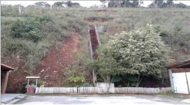
Foto: 1654263140459.jpg ID: 11 Formação de processo erosivo, Talude de corte com solo exposto
