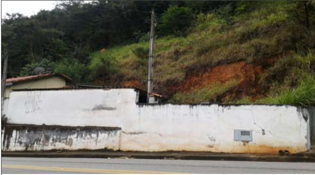
Foto: 1654093751827.jpg ID: 11 Formação de processo erosivo, Moradia sujeita a risco de escorregamento, Presença de cicatriz de escorregamento pretérito, Talude de corte com solo exposto
