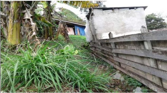
Foto: 1654007324502.jpg ID: 52 Visão geral do setor, Moradia sujeita a risco de escorregamento
