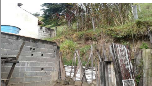
Foto: 1654002584662.jpg ID: 15 Depósito de escorregamento pretérito, Evidência de movimentação no terreno, Formação de processo erosivo, Moradia sujeita a risco de escorregamento, Presença de cicatriz de escorregamento pretérito, Talude de corte com solo exposto
