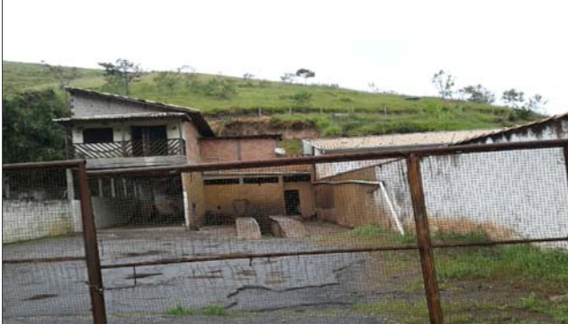
Foto: 1654002448730.jpg ID: 13 Visão geral do setor, Depósito de escorregamento pretérito, Evidência de movimentação no terreno, Formação de processo erosivo, Moradia sujeita a risco de escorregamento, Presença de cicatriz de escorregamento pretérito, Talude de corte com solo exposto
