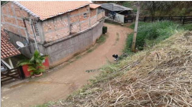
Foto: 1654109749857.jpg ID: 12 Formação de processo erosivo, Presença de cicatriz de escorregamento pretérito, Talude de corte com solo exposto
