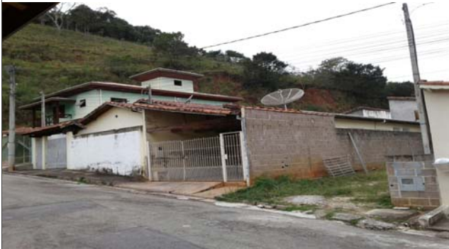
Foto: 1654267219811.jpg ID: 32 Formação de processo erosivo, Moradia sujeita a risco de escorregamento, Talude de corte com solo exposto
