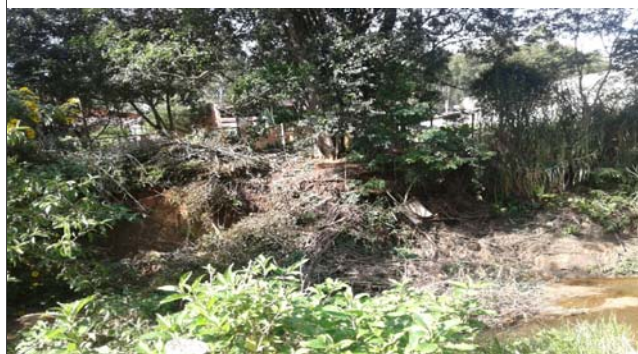
Foto: 1654178192081.jpg ID: 22 Visão geral da drenagem, Detalhe do canal, Detalhe para processo de solapamento no talude, Presença de cicatriz de escorregamento pretérito, Evidência de movimentação em estruturas, Formação de processo erosivo
