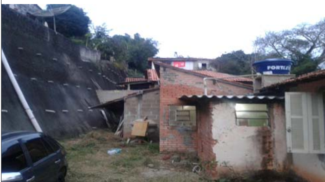
Foto: 1653942129428.jpg ID: 14 Visão geral do setor, Detalhe para intervenção estrutural realizada para mitigação do risco
