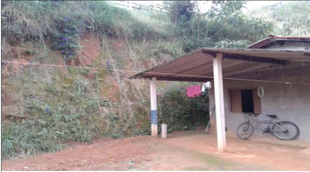
Foto: 1654109571540.jpg ID: 11 Formação de processo erosivo, Moradia sujeita a risco de escorregamento, Talude de corte com solo exposto
