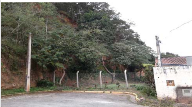
Foto: 1654267295626.jpg ID: 14 Formação de processo erosivo, Talude de corte com solo exposto
