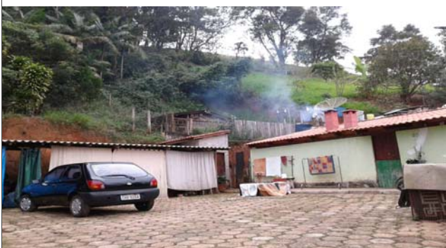
Foto: 1654268637211.jpg ID: 15 Formação de processo erosivo, Moradia sujeita a risco de escorregamento, Talude de corte com solo exposto
