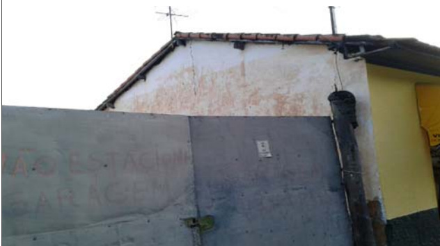
Foto: 1654546402107.jpg ID: 44 Imóveis afetados pelo processo, Detalhe para marca de água
