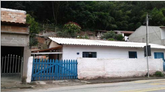
Foto: 1654093912000.jpg ID: 12 Formação de processo erosivo, Moradia sujeita a risco de escorregamento, Talude de corte com solo exposto
