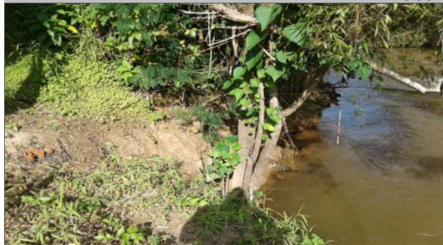
Foto: 1654104138162.jpg ID: 11 Detalhe do canal, Detalhe para processo de solapamento no talude
