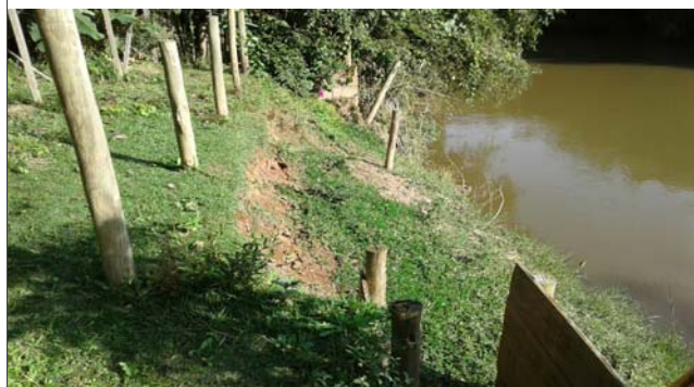
Foto: 1654104966173.jpg ID: 12 Detalhe do canal, Detalhe para processo de solapamento no talude, Formação de processo erosivo
