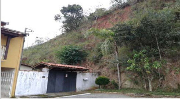
Foto: 1654264155988.jpg ID: 31 Formação de processo erosivo, Moradia sujeita a risco de escorregamento, Presença de cicatriz de escorregamento pretérito, Talude de corte com solo exposto
