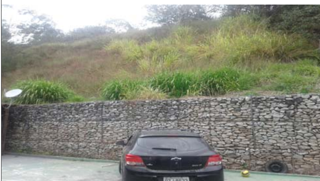
Foto: 1653921932515.jpg ID: 13 Visão geral do setor, Detalhe para intervenção estrutural realizada para mitigação do risco
