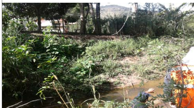
Foto: 1654177982116.jpg ID: 23 Detalhe do canal, Detalhe para processo de solapamento no talude, Presença de cicatriz de escorregamento pretérito, Evidência de movimentação em estruturas
