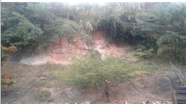
Foto: 1653924209572.jpg ID: 23 Formação de processo erosivo, Presença de cicatriz de escorregamento pretérito, Talude de corte com solo exposto
