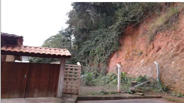
Foto: 1654263837859.jpg ID: 13 Formação de processo erosivo, Talude de corte com solo exposto
