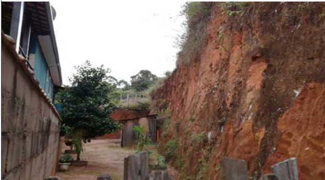
Foto: 1654263642938.jpg ID: 12 Formação de processo erosivo, Talude de corte com solo exposto
