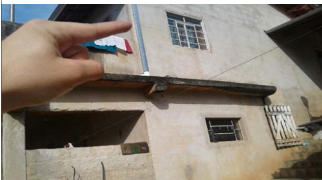
Foto: 1654536812190.jpg ID: 25 Imóveis afetados pelo processo, Detalhe para marca de água
