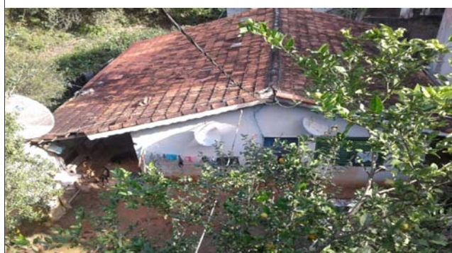
Foto: 1654191347084.jpg ID: 13 Evidência de movimentação em estruturas, Moradia sujeita a risco de escorregamento
