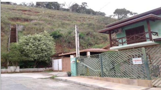
Foto: 1654266976141.jpg ID: 33 Formação de processo erosivo, Moradia sujeita a risco de escorregamento, Presença de cicatriz de escorregamento pretérito, Talude de corte com solo exposto
