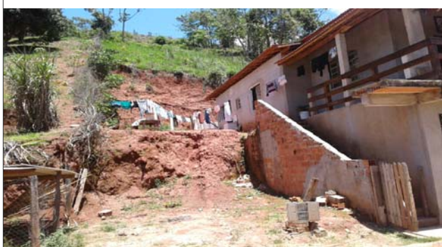
Foto: 1636033223797.jpg ID: 34 Formação de processo erosivo, Moradia sujeita a risco de escorregamento, Talude de corte com solo exposto
