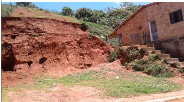
Foto: 1636033030272.jpg ID: 32 Visão geral do setor, Formação de processo erosivo, Talude de corte com solo exposto
