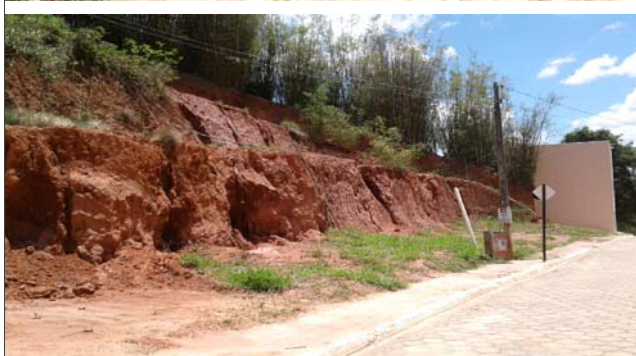
Foto: 1636033805700.jpg ID: 35 Formação de processo erosivo, Talude de corte com solo exposto
