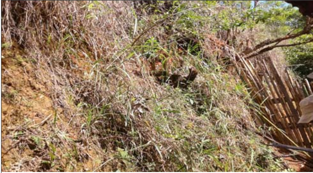
Foto: 1635955820632.jpg ID: 11 Presença de cicatriz de escorregamento pretérito, Talude de corte com solo exposto
