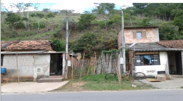
Foto: 1635956049542.jpg ID: 14 Moradia sujeita a risco de escorregamento
