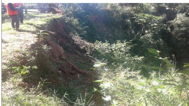
Foto: 1652885525622.jpg ID: 12 Presença de cicatriz de escorregamento pretérito, Formação de processo erosivo
