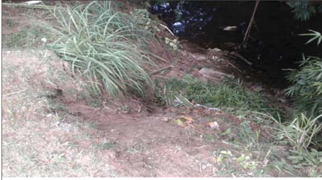
Foto: 1652722635505.jpg ID: 21 Detalhe do canal, Presença de cicatriz de escorregamento pretérito, Formação de processo erosivo, Lançamento de águas/esgoto na superfície
