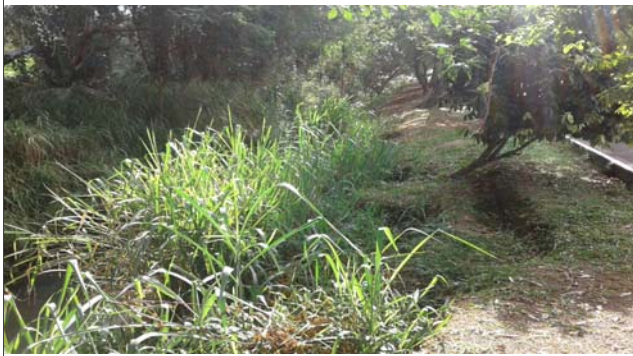
Foto: 1652722885684.jpg ID: 23 Presença de cicatriz de escorregamento pretérito, Evidência de movimentação no terreno, Formação de processo erosivo
