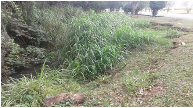
Foto: 1652722723855.jpg ID: 22 Detalhe do canal, Presença de cicatriz de escorregamento pretérito, Evidência de movimentação no terreno, Formação de processo erosivo
