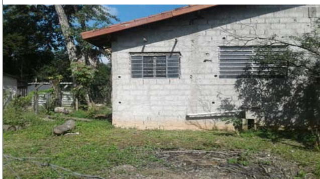
Foto: 1652104370268.jpg ID: 24 Limite da área atingida pelo processo, Imóveis afetados pelo processo, Detalhe para marca de água
