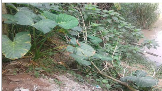
Foto: 1652280495775.jpg ID: 12 Detalhe para processo de erosão, Detalhe para processo de solapamento no talude, Depósito de escorregamento pretérito, Presença de cicatriz de escorregamento pretérito, Evidência de movimentação no terreno, Formação de processo erosivo
