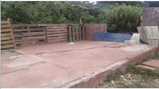
Foto: 1652360139723.jpg ID: 22 Evidência de movimentação em estruturas
