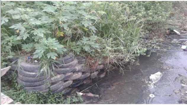
Foto: 1652361728909.jpg ID: 24 Visão geral da drenagem, Presença de cicatriz de escorregamento pretérito, Formação de processo erosivo
